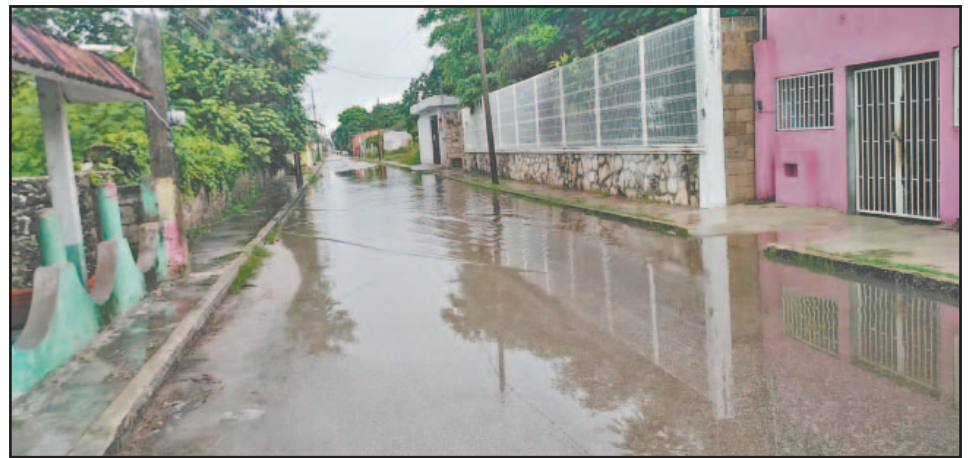
Los encaramientos de los últimos días esconden el riesgo que son los socavones.
