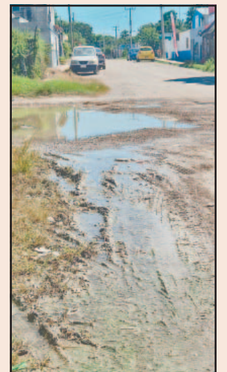
Los vecinos piden la reparación de la vialidad.
