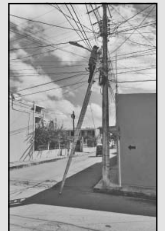
Tramos sin luz aumentan el peligro al transitar. (P. Díaz)
