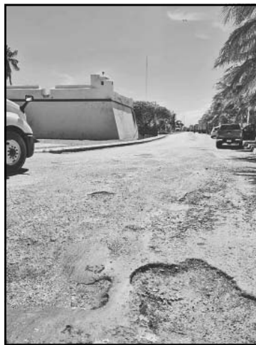
Baches y desgaste del pavimento dificultan el tránsito. (Jorge May)
