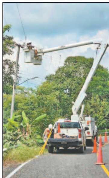
Retiran las ramas y árboles del cableado eléctrico. (Juan Vargas)
