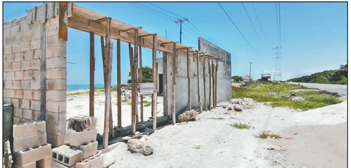
Hay obras inconclusas a solo tres metros de la carretera, lo cual supone fuerte riesgo. (Perla Prado)
