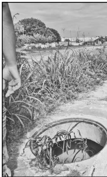
El riesgo de caídas está latente, sobre todo de noche. (Jorge May)
