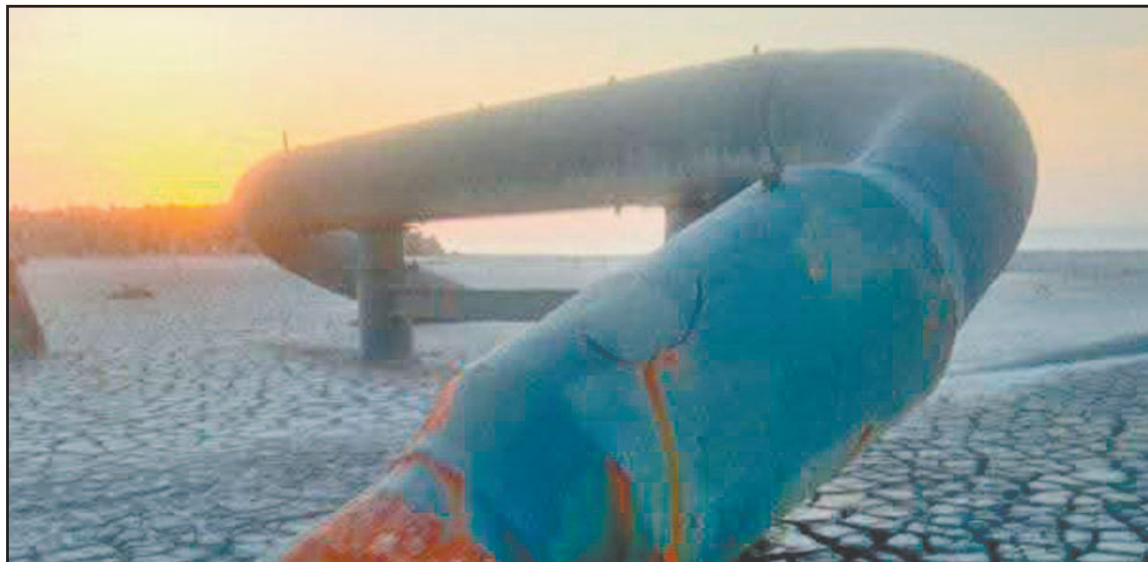
Vecinos denunciaron el deterioro de las tuberías; sólo personal indispensable permanece en el lugar.
