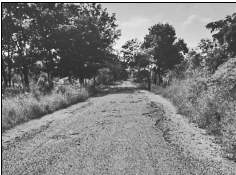
Los numerosos hoyancos provocan afectaciones. (Juan Vargas L.)
