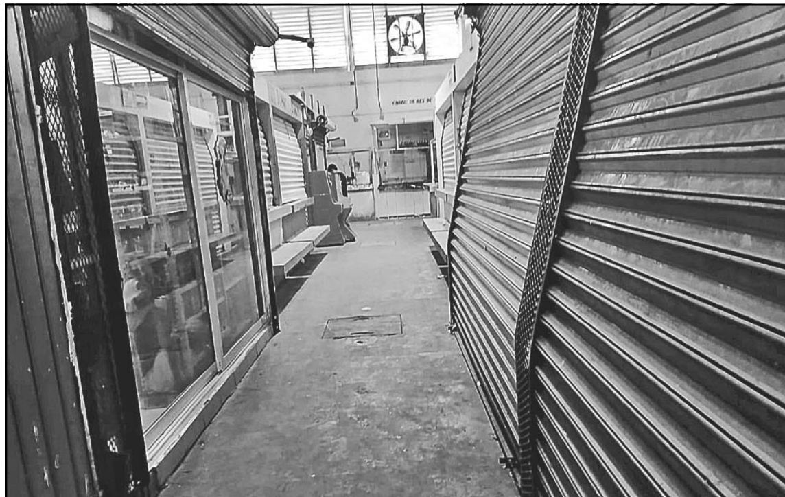
La falta de mantenimiento del recinto ahuyenta a compradores y a los visitantes, señalan. (Joaquín Guevara)
