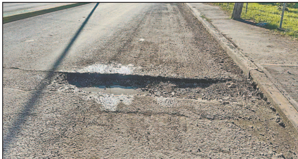
El hoyanco fue originado por una reparación en la instalación de un tubo de desagüe.
