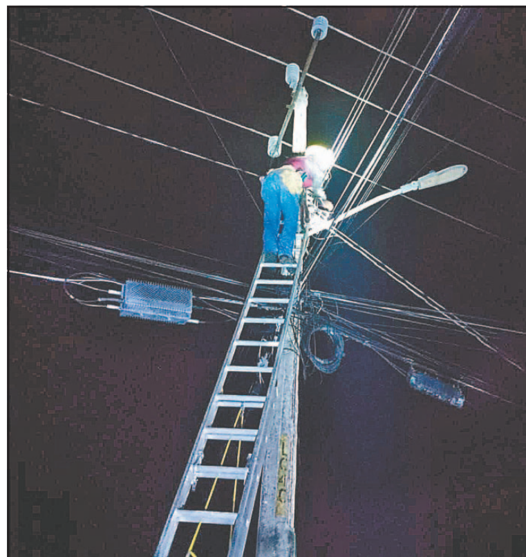
El mal estado de cables provocó la ruptura de líneas eléctricas. (P. Díaz)
