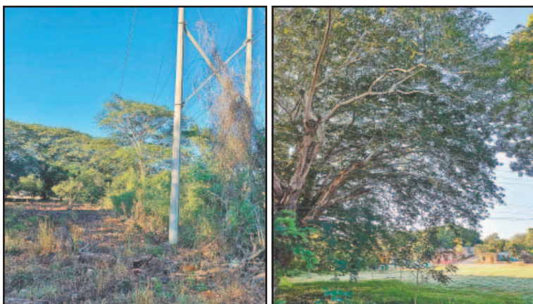
Se trata del tendido eléctrico que alimenta a la ciudad. (Mauriel Koh)
