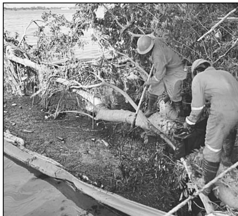
El hidrocarburo se dispersó en los ríos Pantepec y Tuxpan . (POR ESTO!)
