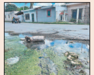
Los vecinos prevén accidentes.
