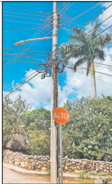
Parte de la estructura se cae a pedazos. (Amado Caamal)
