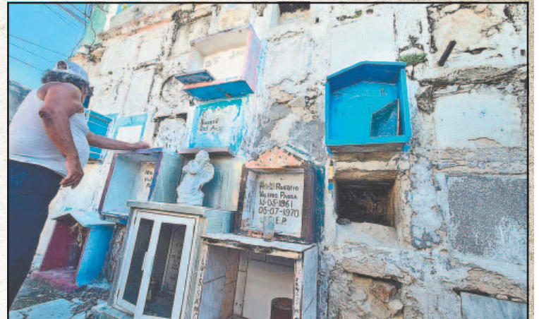
Debido al daño estructural, no ha sido posible restaurar varias tumbas.
