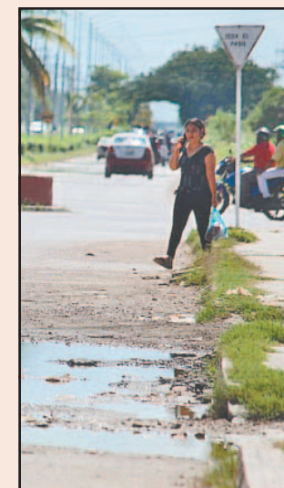
El pavimento ya se rompió; hace poco fue rehabilitado.
