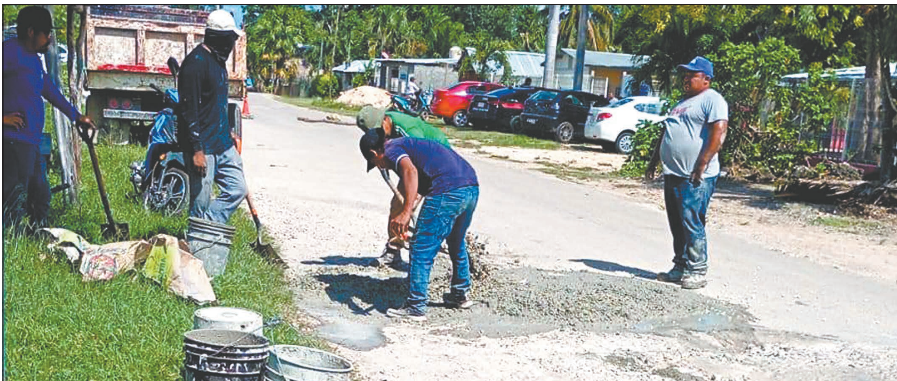
Residentes señalaron que el tránsito en la vialidad se vuelve riesgoso, especialmente de noche por la poca iluminación; además, los charcos dificultan el paso de los peatones. (PorEsto!)
