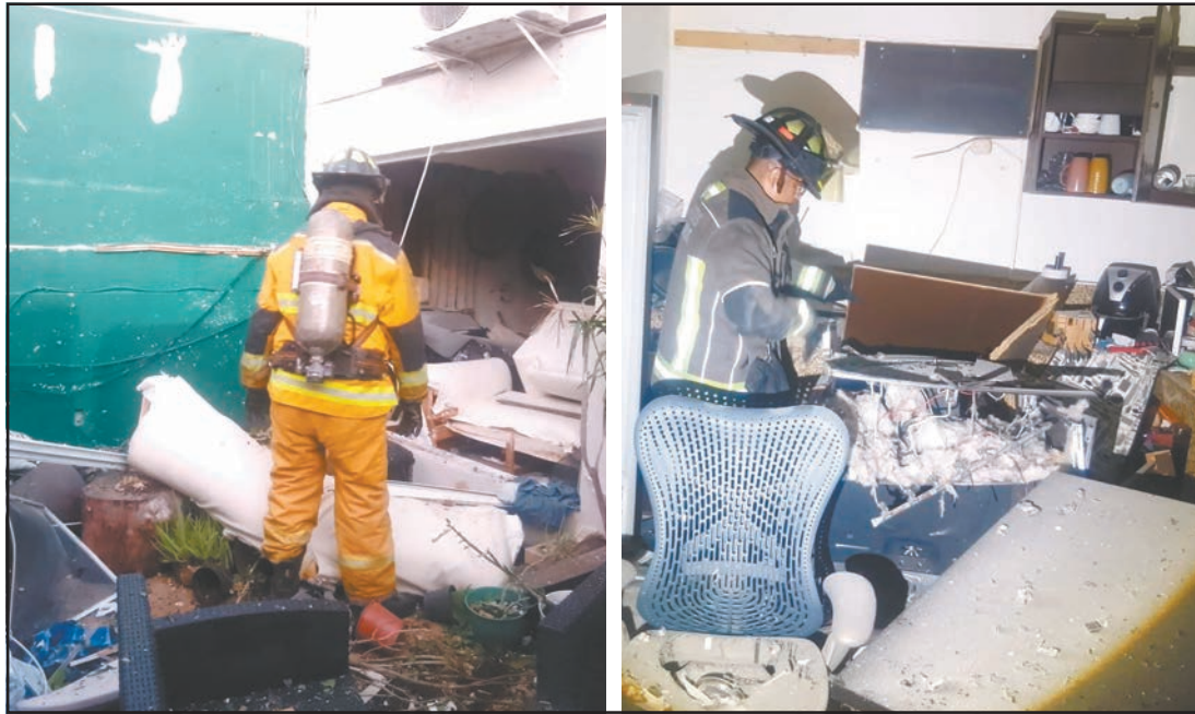
Debido a la destrucción, Protección Civil dictaminó que el inmueble principal no es habitable. (Fotos PorEsto!)
