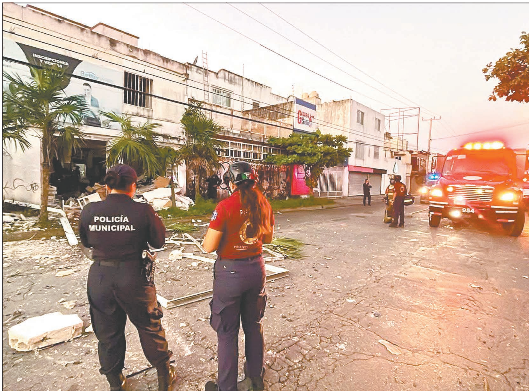
Personal de Protección Civil aseguró que la vivienda ya no era habitable, mientras que, en las casas vecinas, las afectaciones podrían tener reparación. (Leonardo Chacón)
