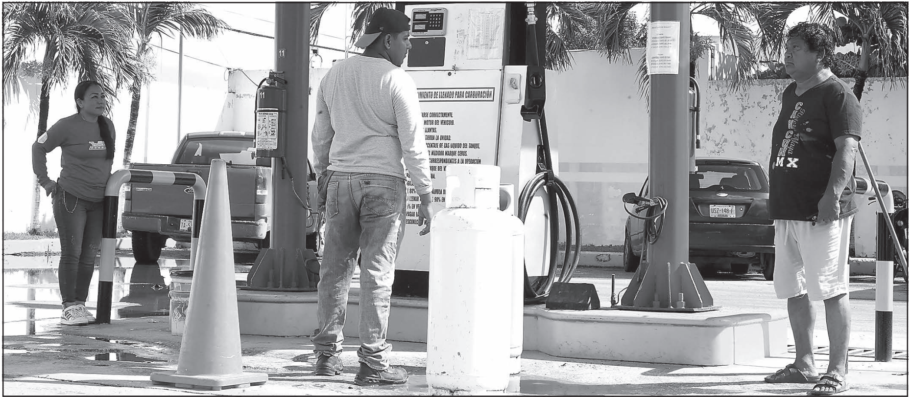
Muchas veces, a pesar de que los tanques están oxidados o tienen problemas en las válvulas, los trabajadores brindan el servicio, sin importar los riesgos. (Rodolfo Flores)
