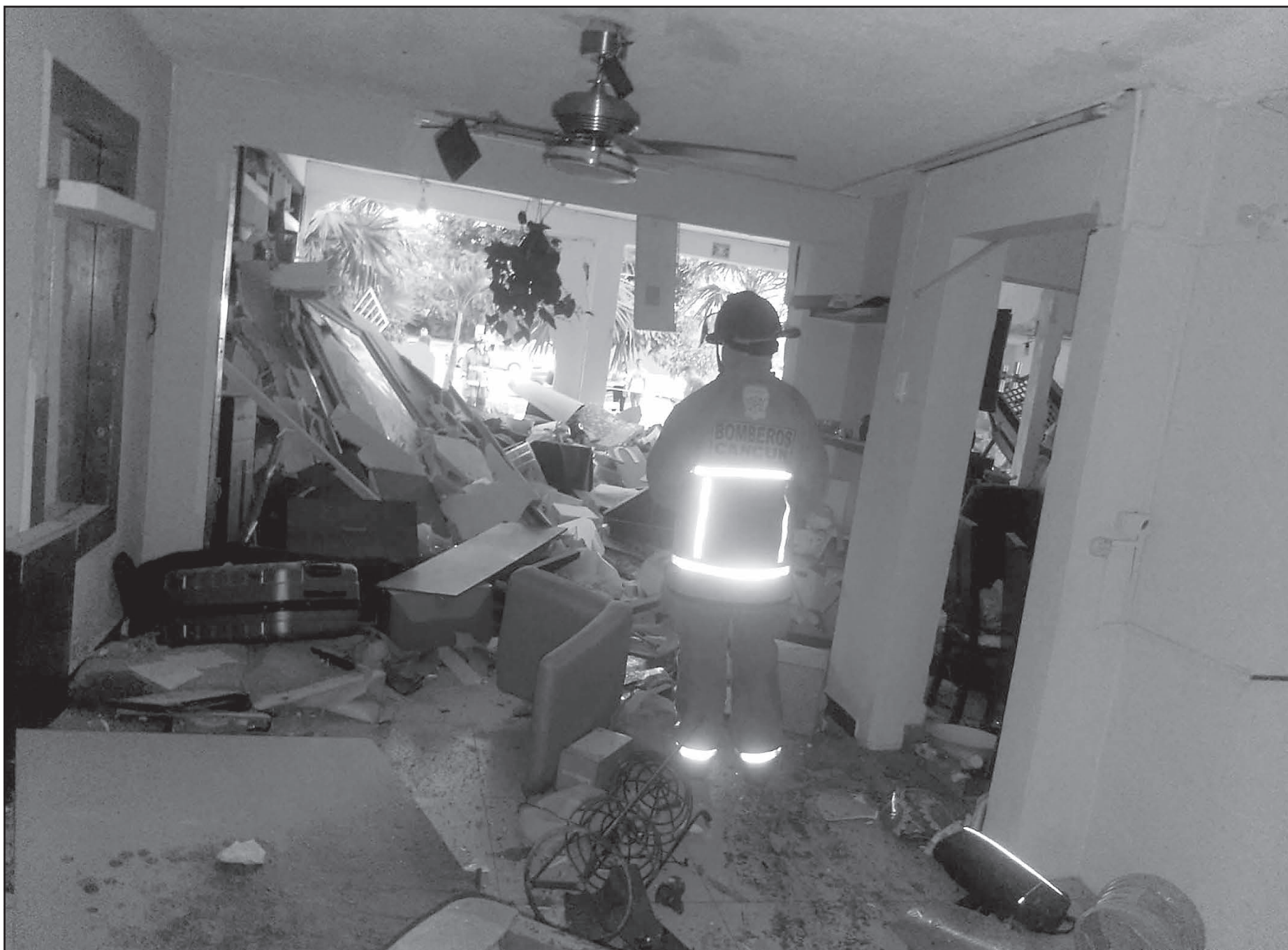
El acumulamiento del energético generó ayer una fuerte explosión en un inmueble que fungía como bodega, ubicada en la Supermanzana 51 y dejó cuantiosos daños. (PorEsto!)
