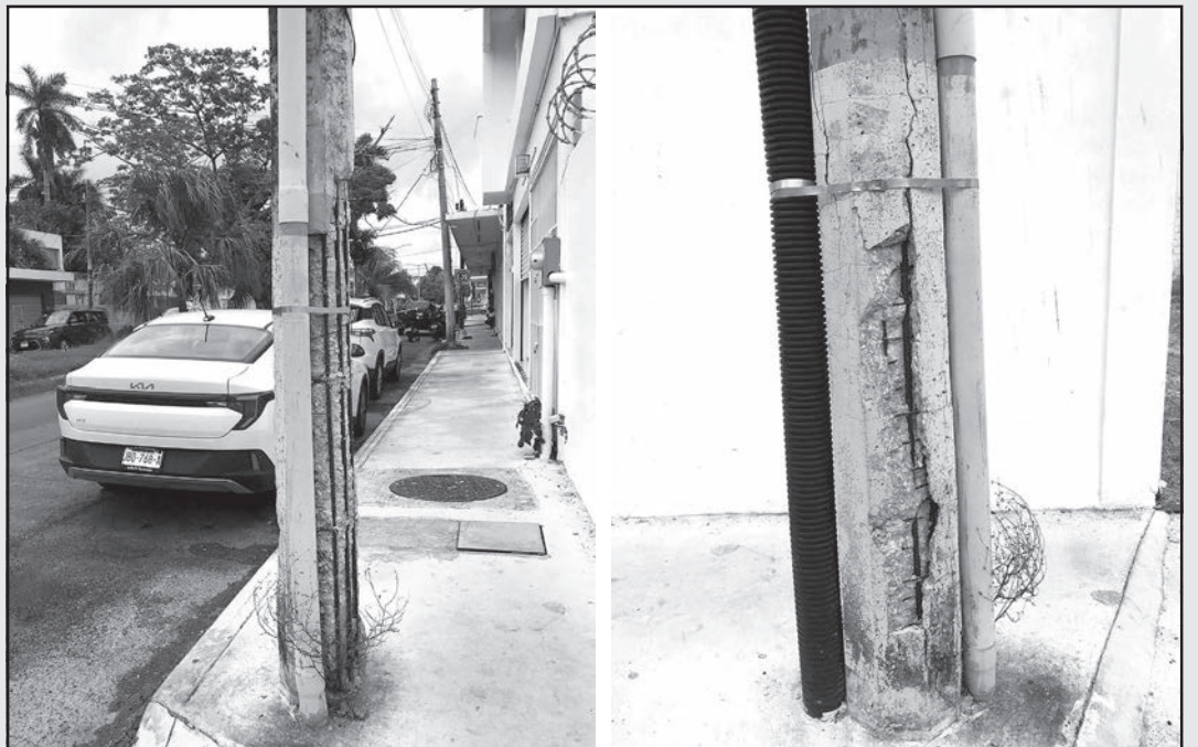
La infraestructura de la paraestatal luce con varillas expuestas y falta de concreto. (Fotos A. Chamlati)
