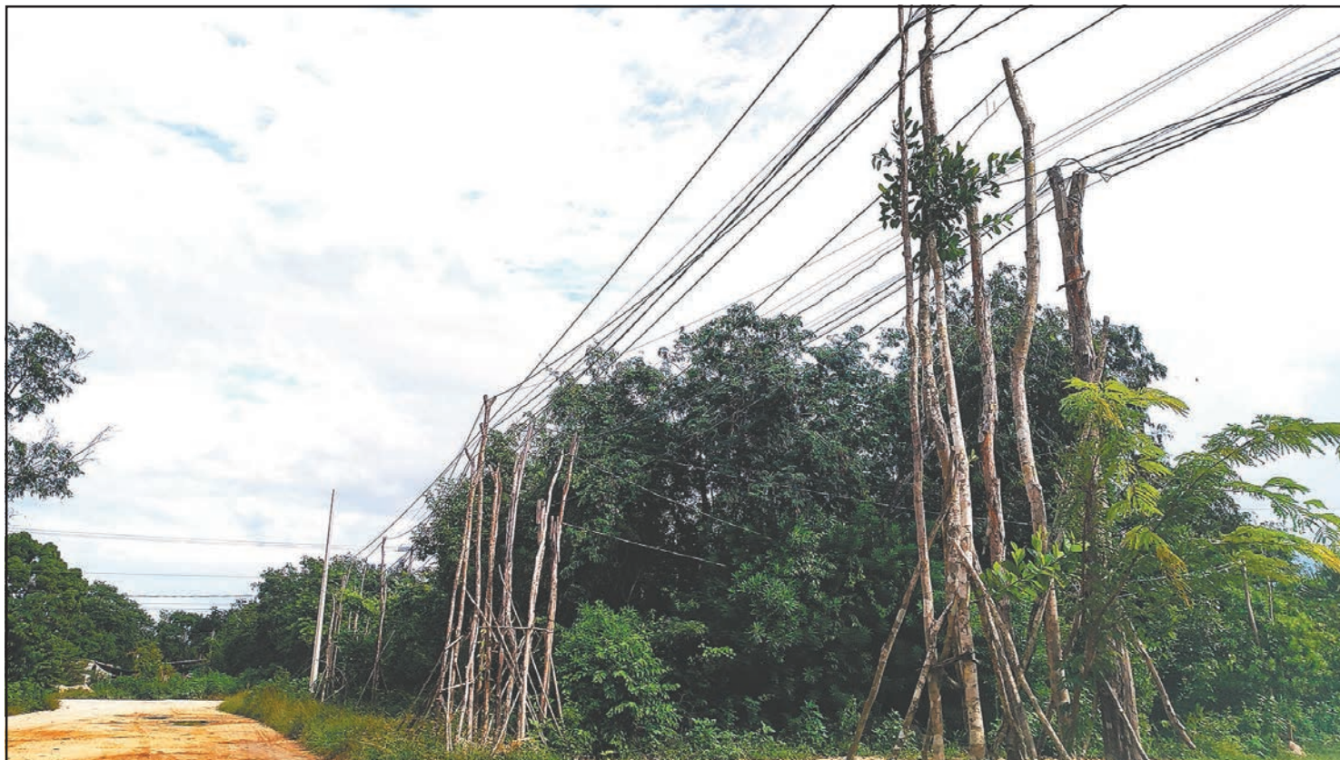
Troncos de árboles sostienen infinidad de cables que se caen a la terracería cuando hay precipitaciones fuertes. (Fotos Mario Hernández)
