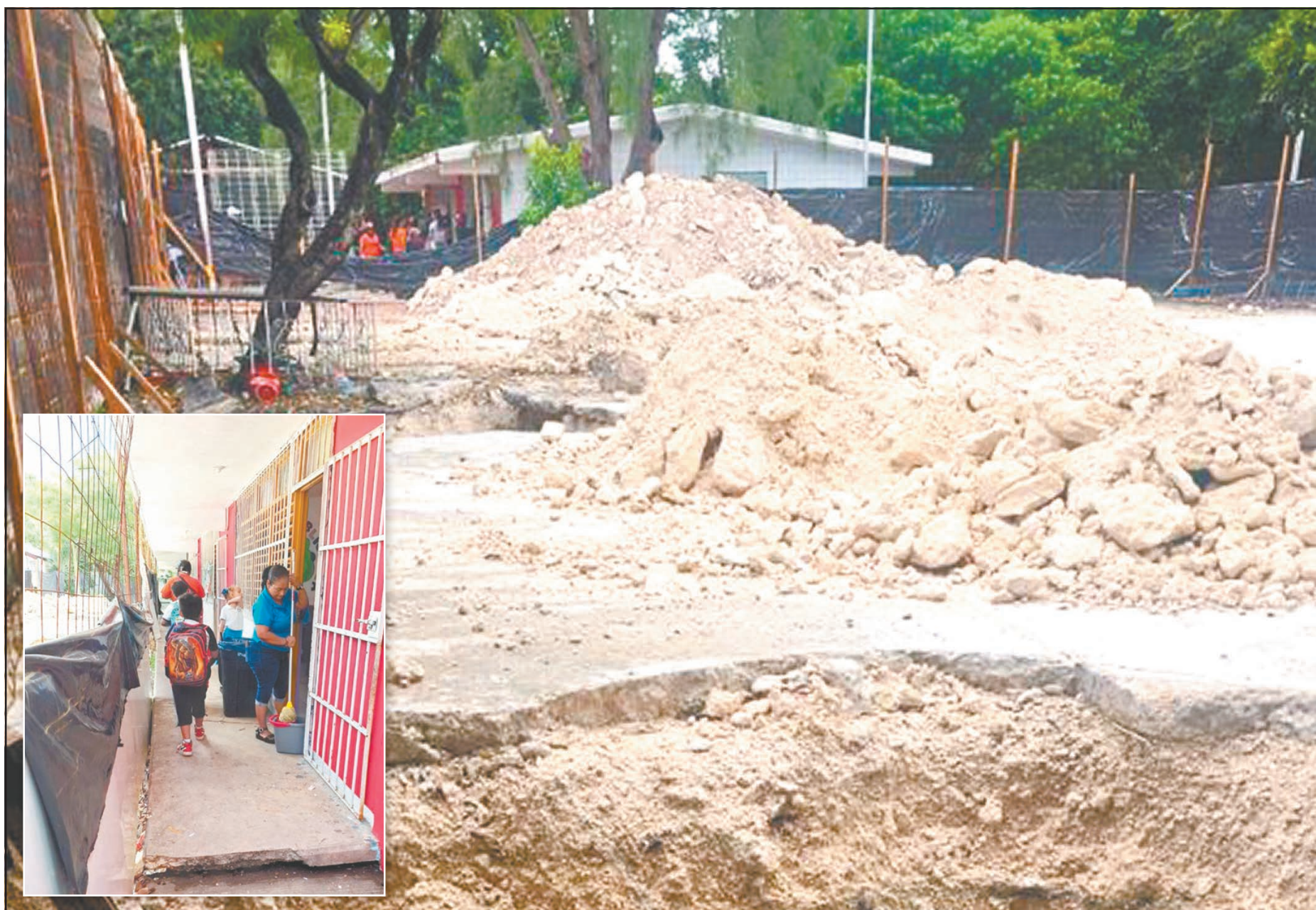
Las lluvias y el abandono de los materiales en la escuela han convertido el área en un terreno lodoso, con varillas expuestas y maquinaria oxidada que es un peligro para los niños. (A. Blanco)
