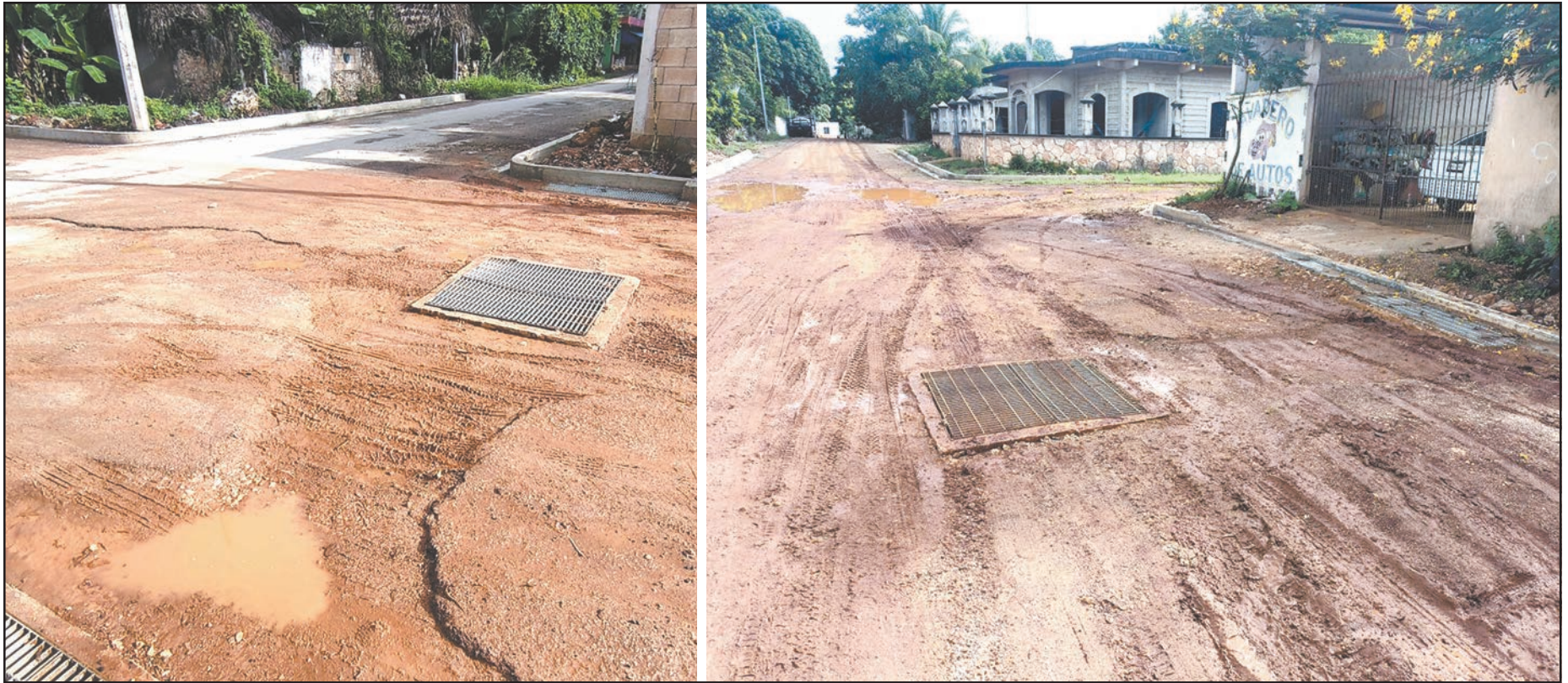
En las vialidades donde se hicieron reparaciones y colocación de alcantarillas quedó un lodazal, lo que complica la circulación y genera serias complicaciones. (Lusio Kauil)
