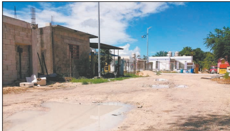
La infraestructura presenta varios cables oxidados, derivado de la salinidad del mar.
