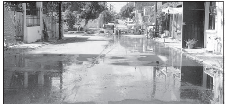
Un charco de 100 metros afecta en la calle principal. (Liza Vera)
