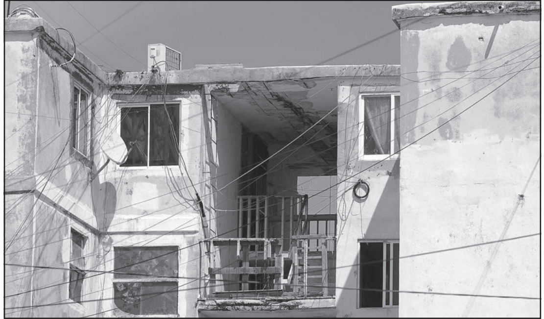
Hace años cayó una escalera y autoridades dijeron que la construcción tenía fallas. (Fotos M. Hernández)
