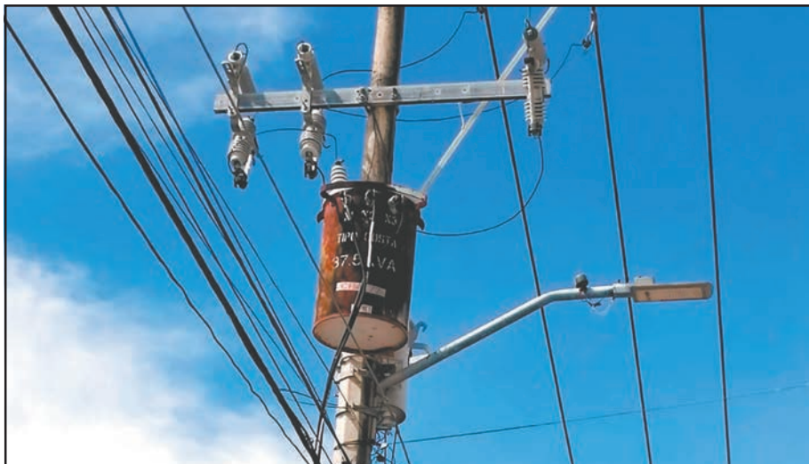
Según los quejosos, invasores de lotes hacen conexiones ilegales y dañan los transformadores.
