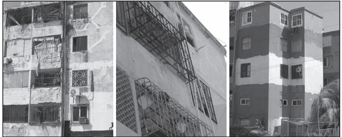
El pésimo estado de los departamentos es visible a varios metros de distancia, lo que genera miedo.
