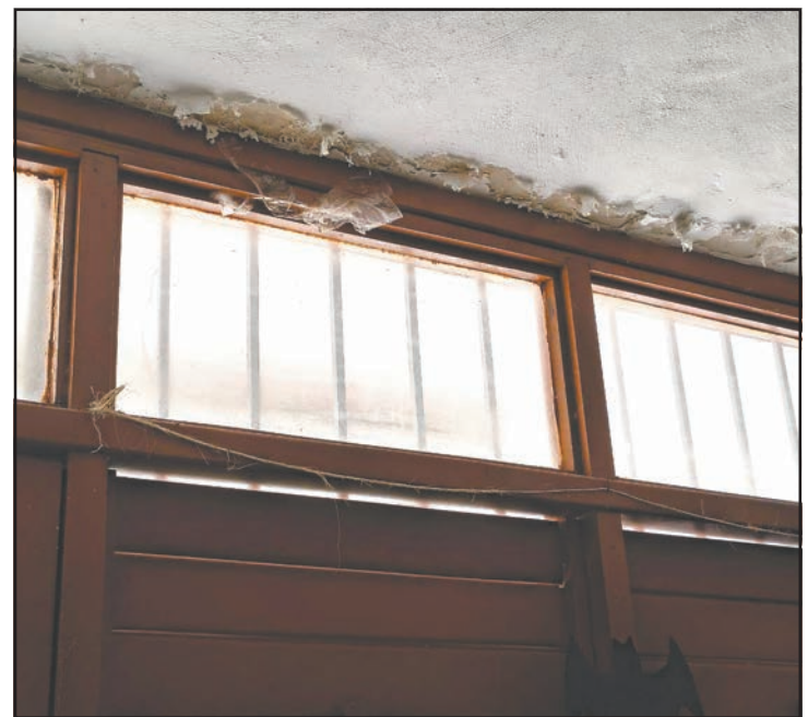
Las fotos evidencian los daños por falta de mantenimiento. (PorEsto!)
