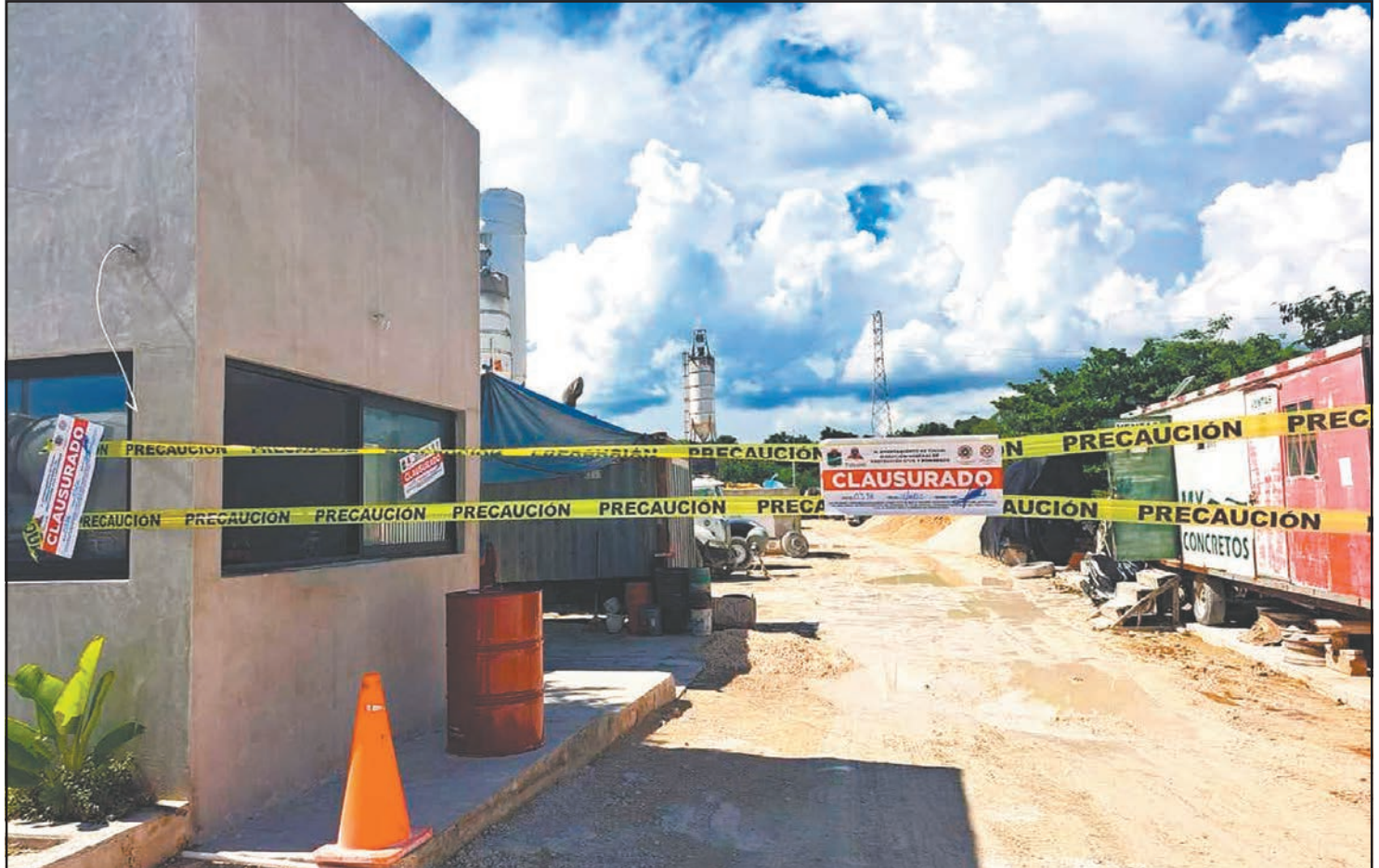
Inspección de Protección Civil encontró incumplimiento en manejo de residuos y riesgo para acuíferos del Caribe Mexicano. (A. Bee)
