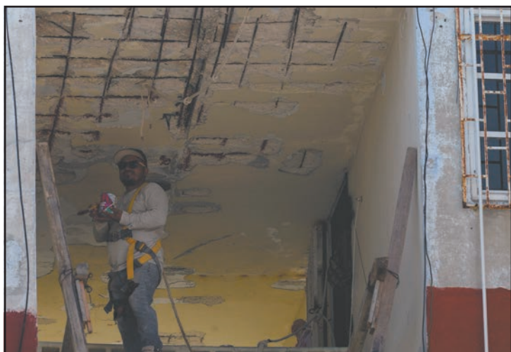
Moradores viven con temor de colapso en edificios. (Mario Hernández)
