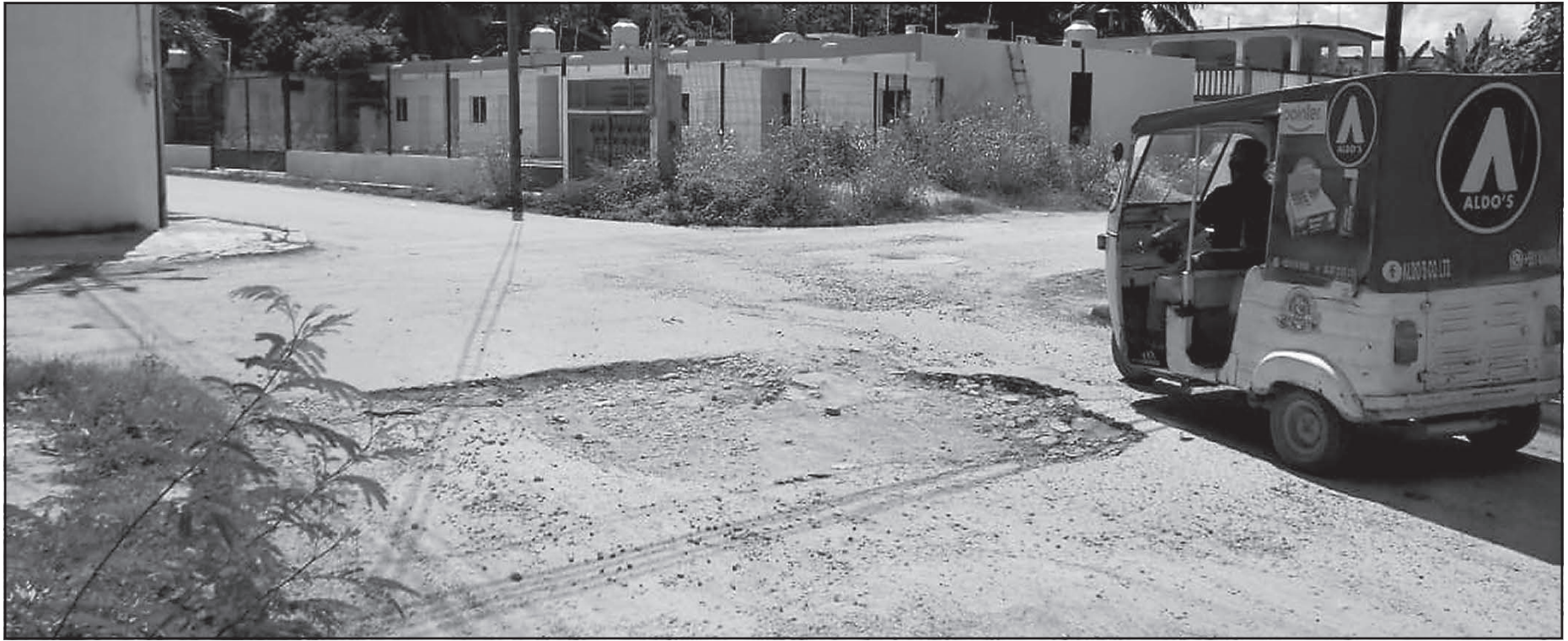
Las calles de la comunidad están hechas pedazos; prestadores de transporte se quejan debido a que están prácticamente intransitables y dañan las unidades. (Fotos Williams Duran)
