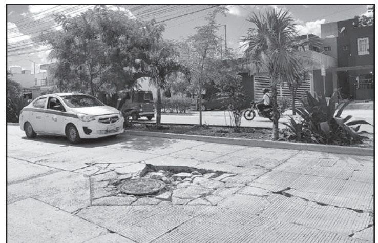
La carpeta asfáltica se encuentra levantada en la Región 107. (M. Hernández)
