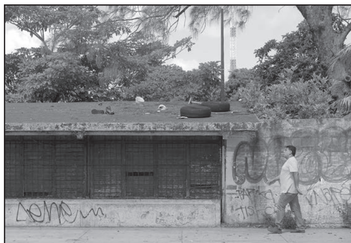
Se aprecia concreto agrietado en la casa de estudios. (Mario Hernández)
