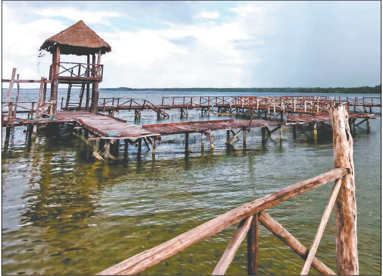
Un muelle ubicado en el interior de la reserva estatal se encuentra en ruinas y cayéndose a pedazos en algunas partes. (Fotos Anahí Chamlati)
