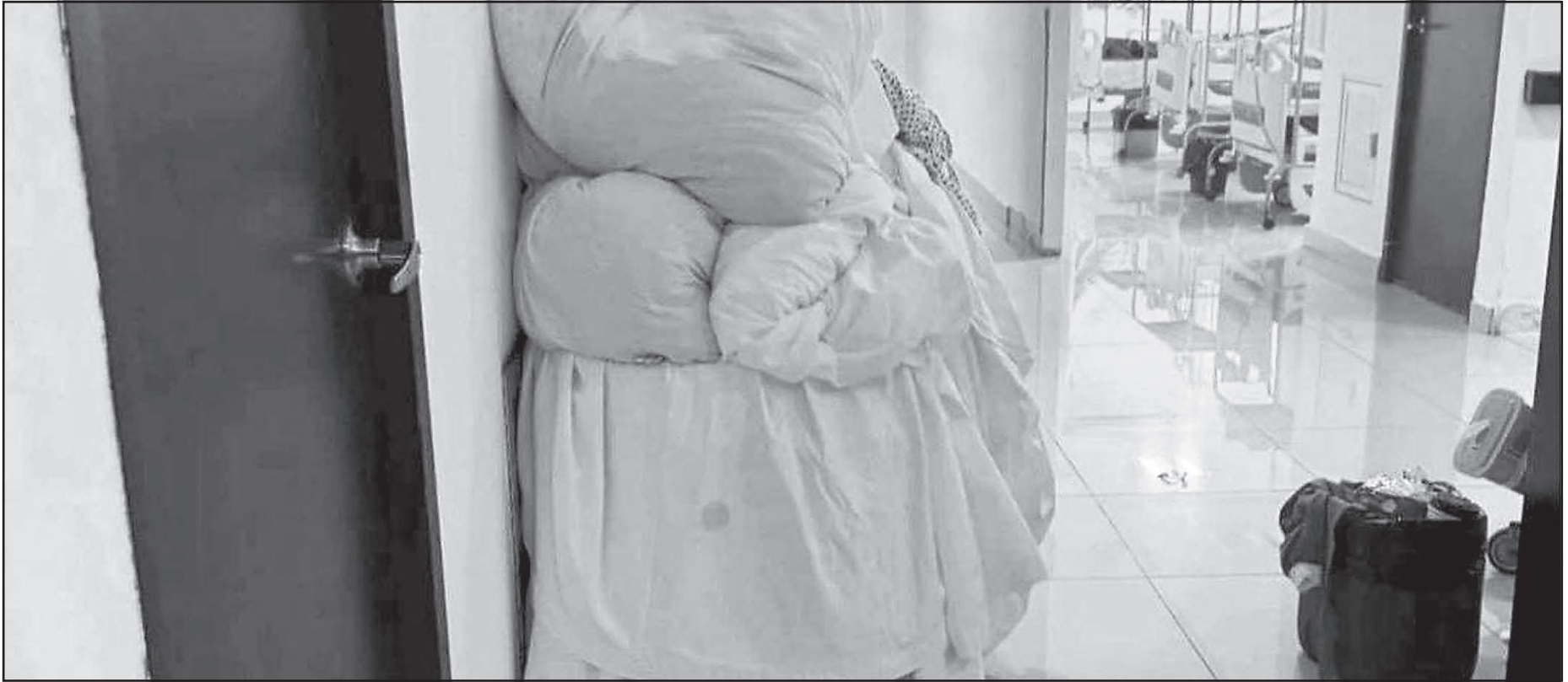
Filtraciones en techos, hacinamiento de enfermos y escasez de insumos ponen en riesgo la salud en el nosocomio de Sesa, de acuerdo con derechohabientes. (G. Escalante)
