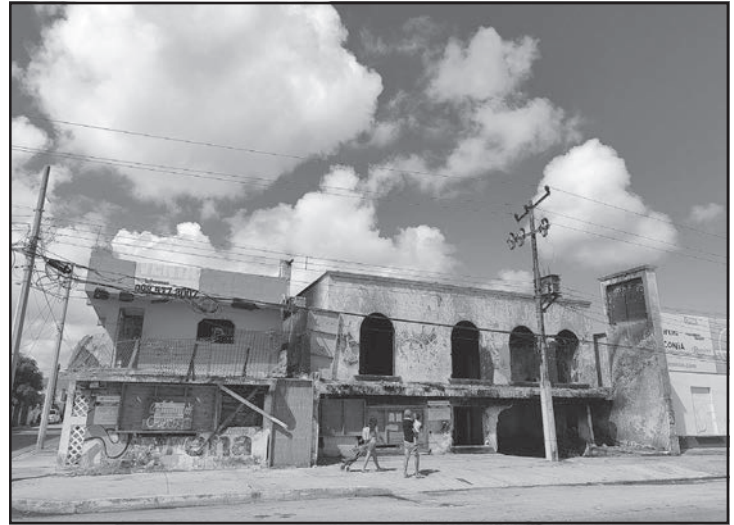
En la avenida López Portillo hay al menos dos edificios descuidados.
