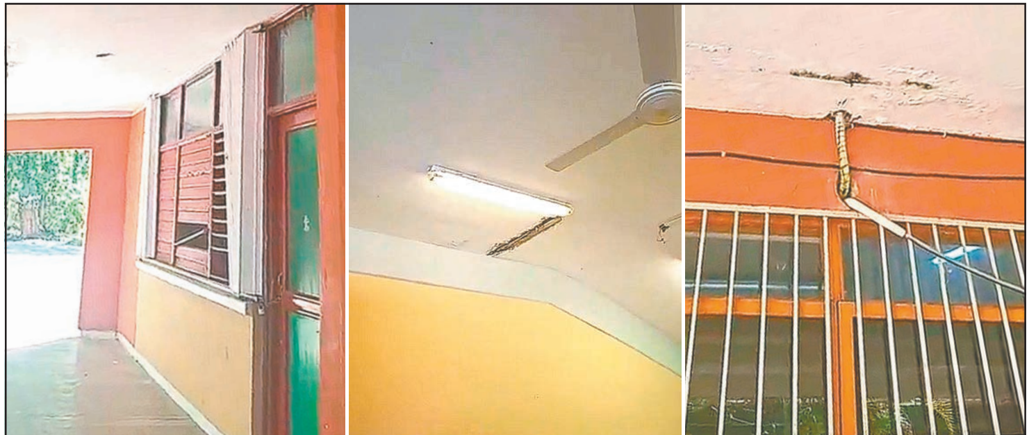
Un edificio, usado como refugio anticiclónico, está tan dañado que representa riesgo. Exigen la intervención de autoridades. (PorEsto!)
