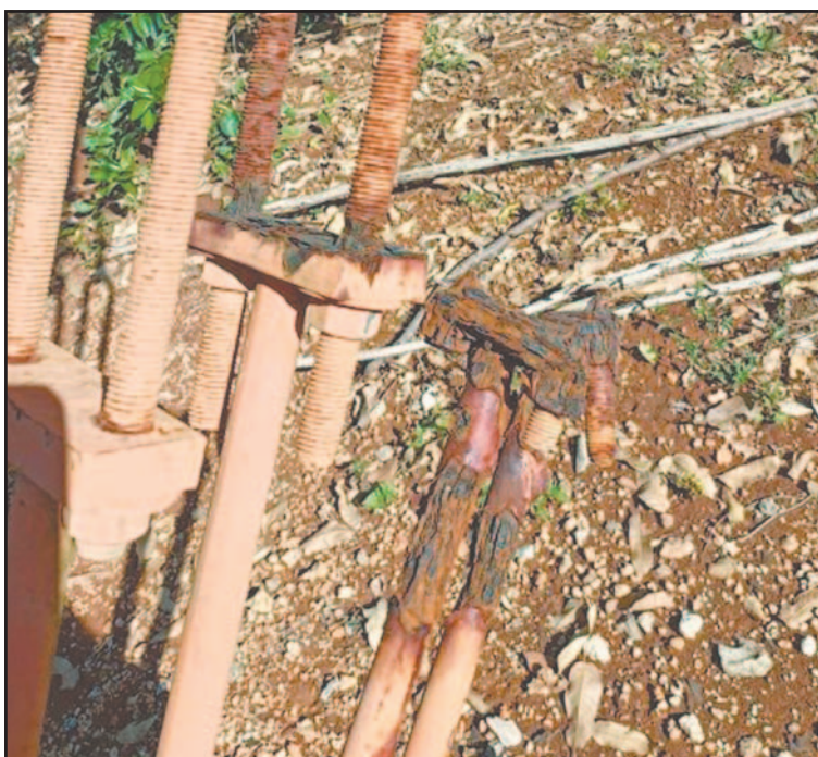
Puntos de anclaje de la estructura están muy oxidados. (Lusio Kauil)
