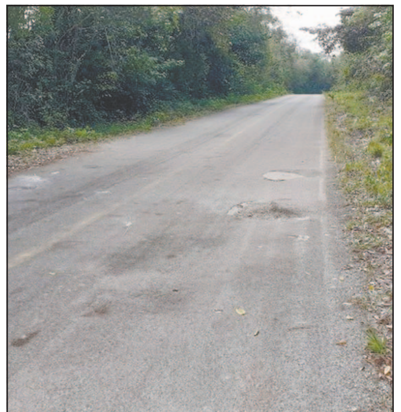
El tramo vial La Candelaria-Puerto Arturo está muy dañado. (L. Kauil)
