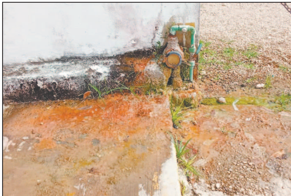
Pobladores dijeron que les frustra tener que pagar un servicio deficiente. (Fotos E. Cauich)
