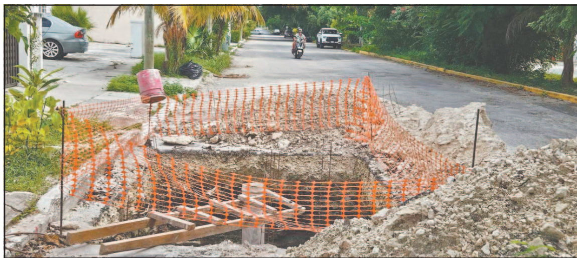
El pozo inconcluso representa un peligro constante para peatones y automovilistas locales. (G. Alcocer)
