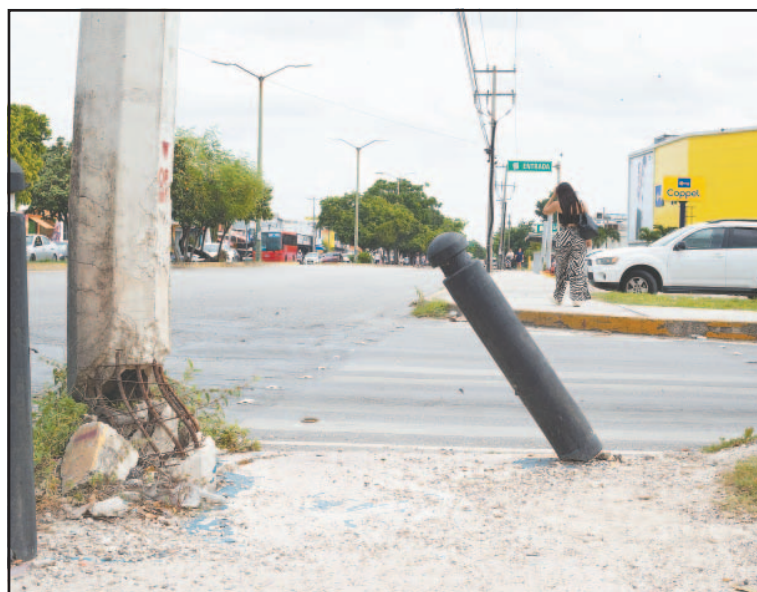
Usuarios pidieron reparar postes a punto de caer. (Rodolfo Flores)
