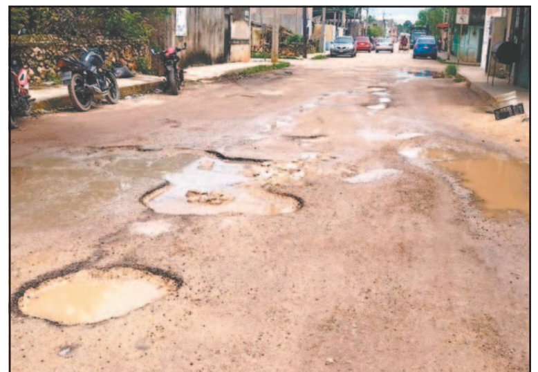
Conductores señalan que hay tramos que tienen hasta tres huecos.
