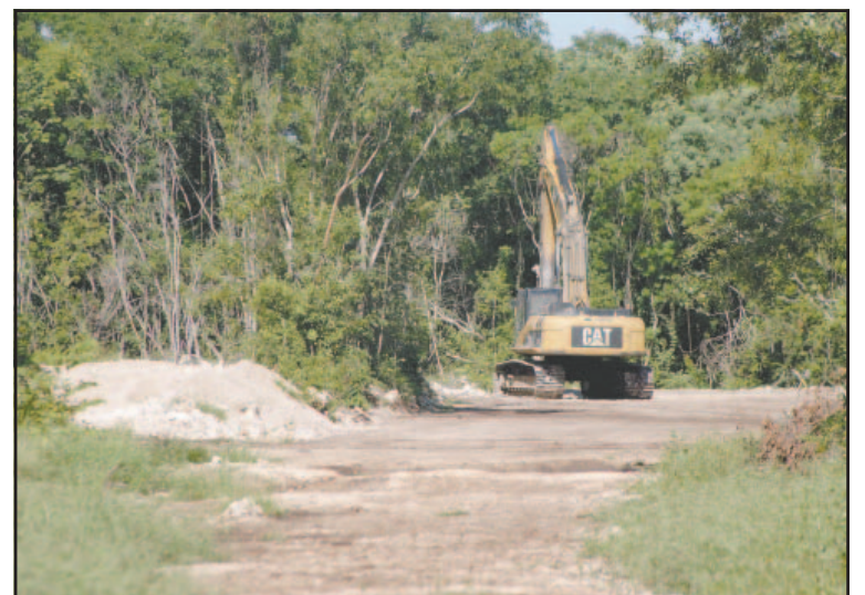
Las calles carecen de pavimento y además hay obras inconclusas.
