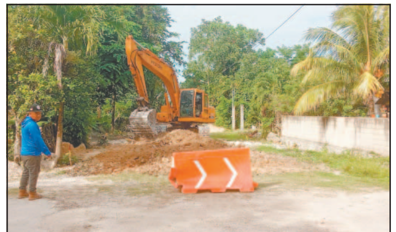
La obra se hace con un presupuesto de 940 mil pesos. (E. Cauch)
