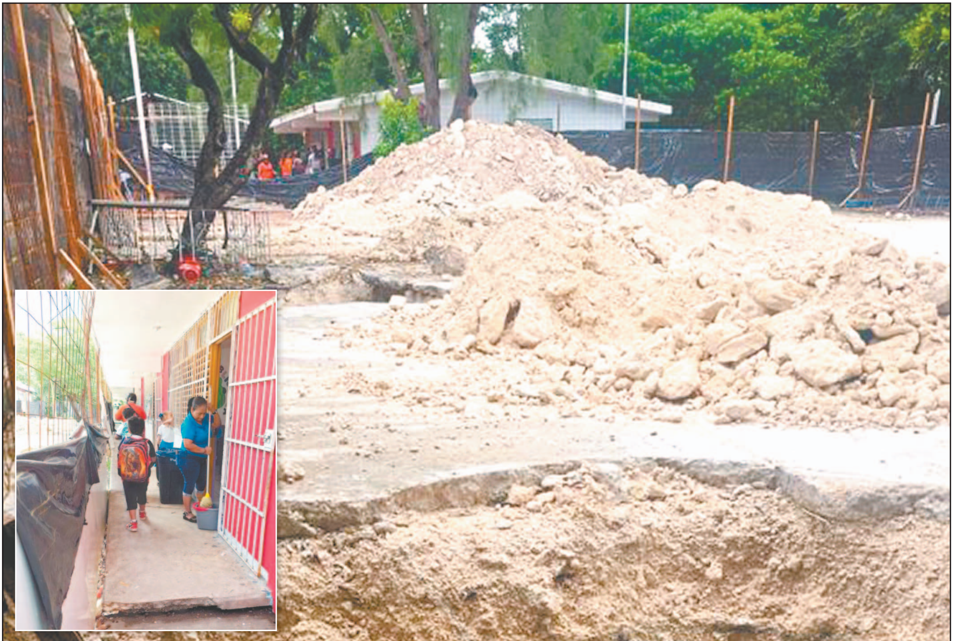
Las lluvias y el abandono de los materiales en la escuela han convertido el área en un terreno lodoso, con varillas expuestas y maquinaria oxidada que es un peligro para los niños. (A. Blanco)
