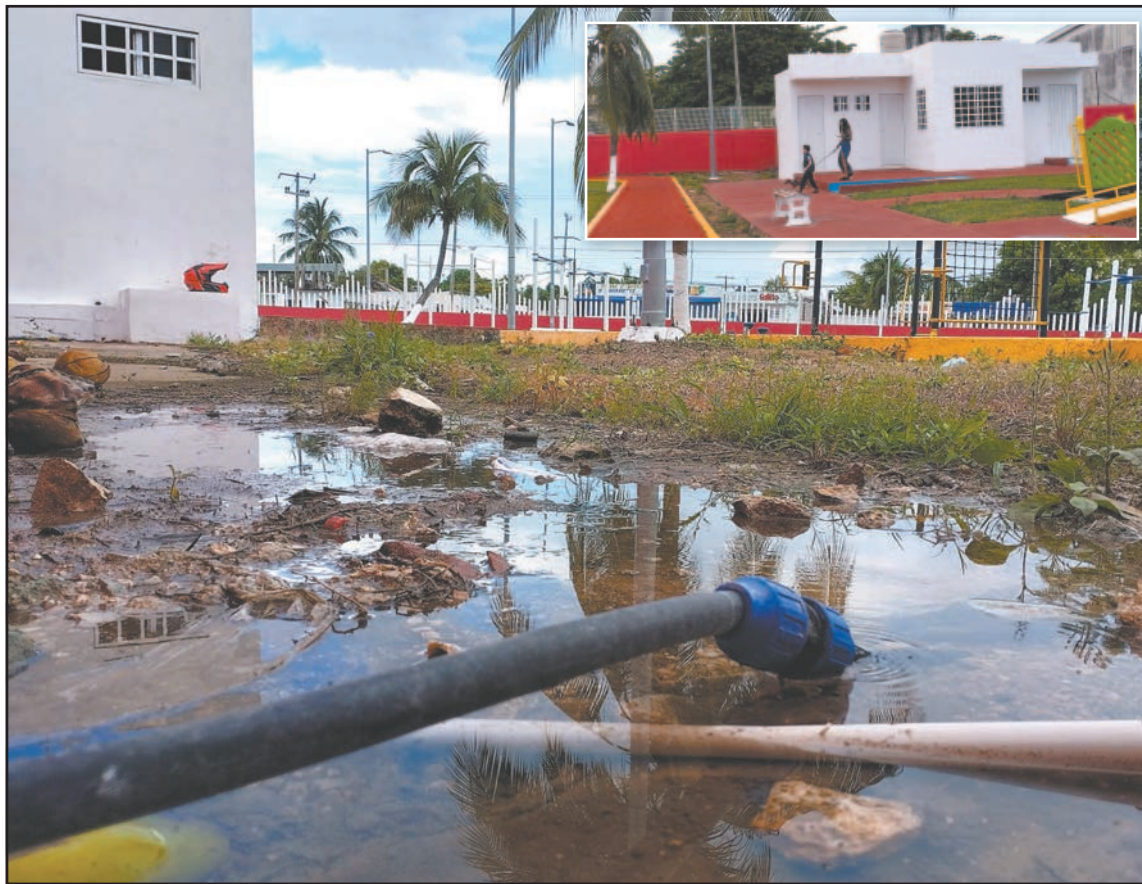
Una avería en la tubería ubicada en el Parque de la Mujer causa escasez en el sistema hídrico. (Fotos W. Duran)
