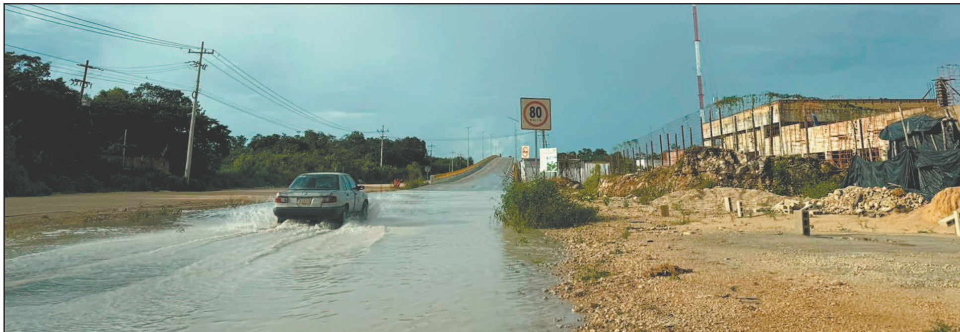
Al bajar el puente, llegando de Valladolid, el agua supera los 30 centímetros de altura, debido a que la elevación del carril aledaño no permite drenar el líquido. (Justino Xiu)
