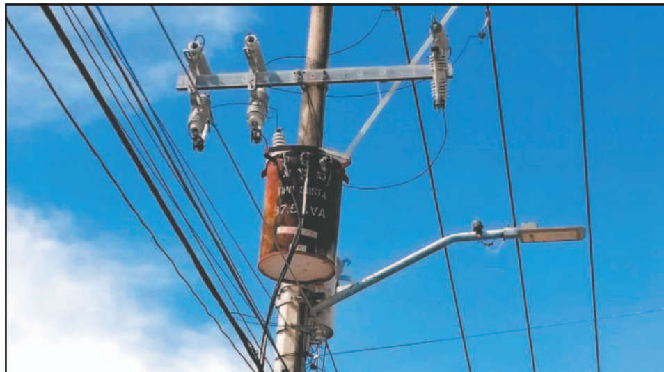
Según los quejosos, invasores de lotes hacen conexiones legales y dañan los transformadores.
