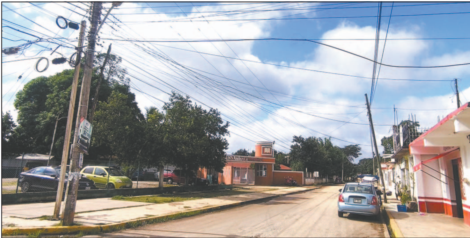
Padres de familias coincidieron en que las estructuras, que están inclinadas, representan un peligro en la calle Benito Juárez. (Lusio Kauil)
