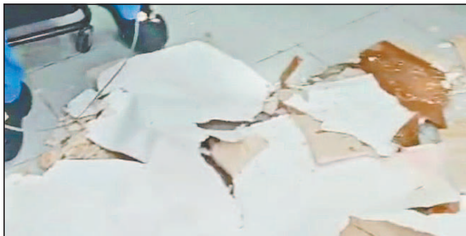
Los daños fueron atribuidos a la humedad acumulada y a la falta de mantenimiento.
