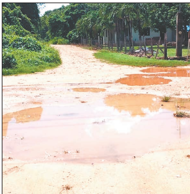
Un tramo de la vía José María Morelos está intransitable. (E. Cauch)
