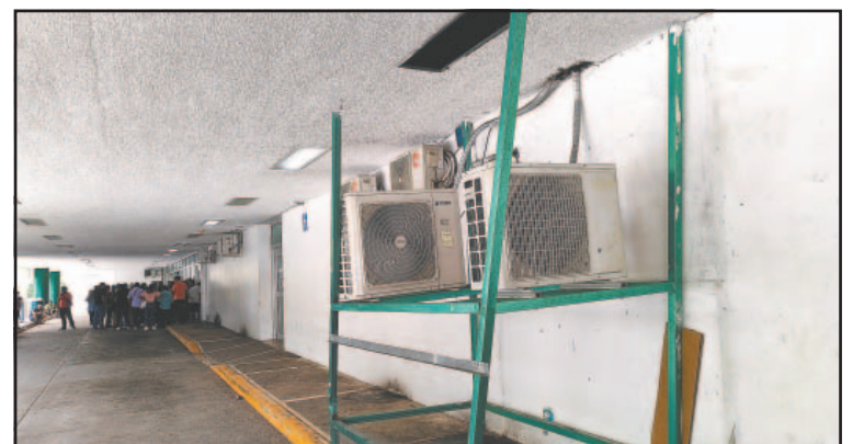
Compresores están colocados de forma peligrosa. (Mario Hernández)
