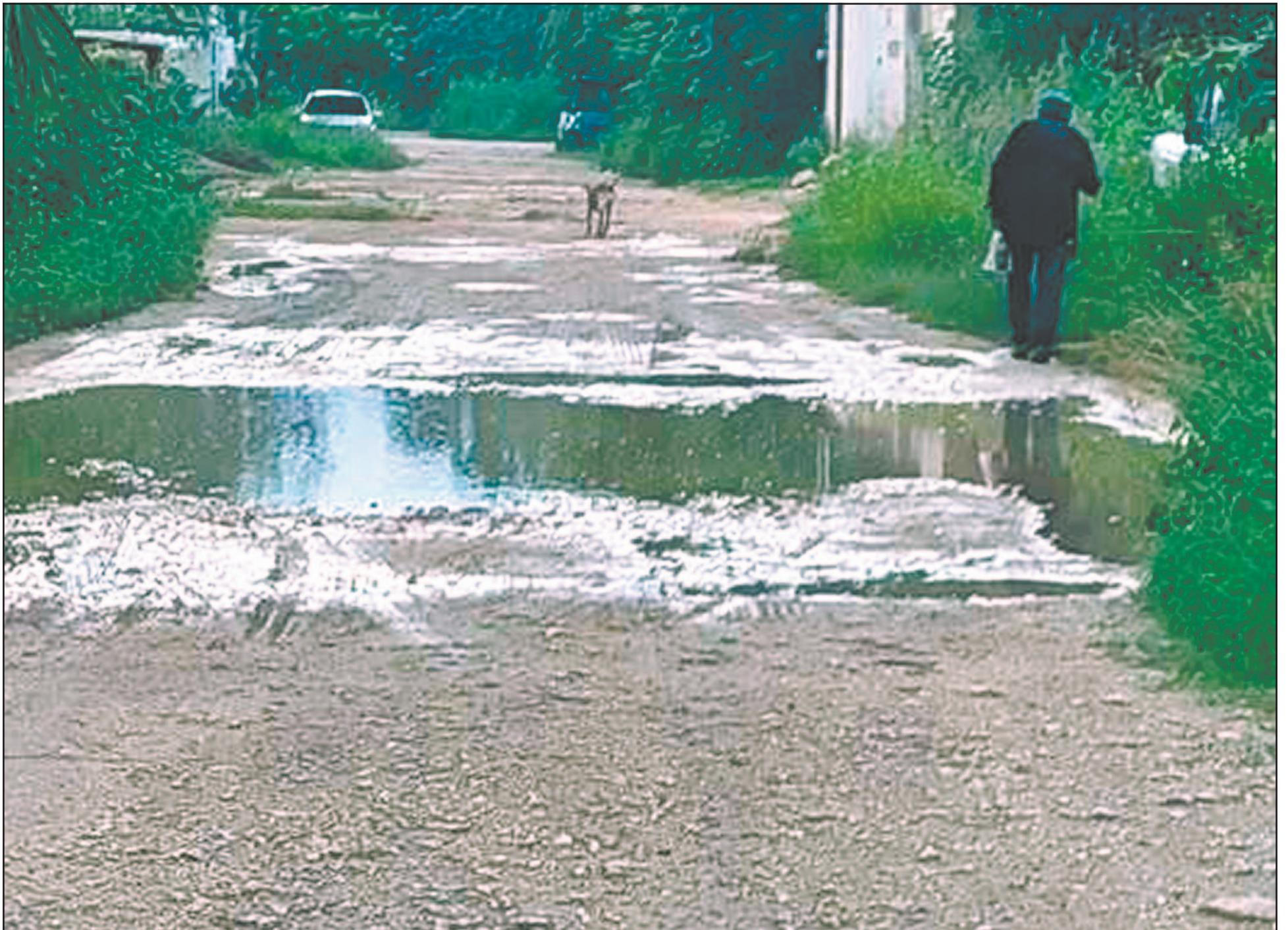
El encharcamiento permanente y la falta de pavimento en vialidades de Lázaro Cárdenas revelan años de olvido en zonas habitacionales, como Miguel Borge Martín. (E. Cauich)
