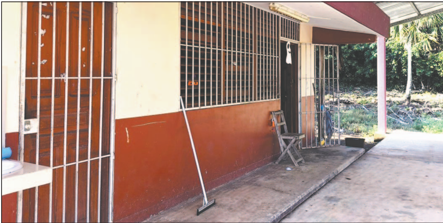
Plantel educativo tiene deficiencias en baños, debido a las tuberías dañadas; jóvenes tienen que usar los de sus casas. (Lusio Kauil)
