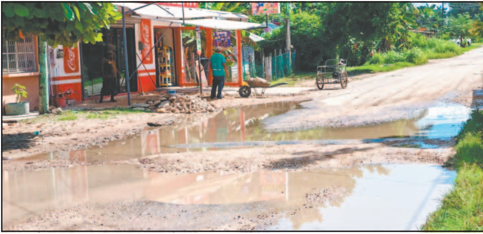
La humedad constante provoca que unos ocho metros de calle estén llenos de baches.
