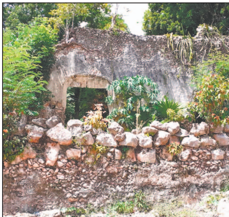
Escombros de un edificio cayeron sobre una vialidad. (Lusio Kauil)
