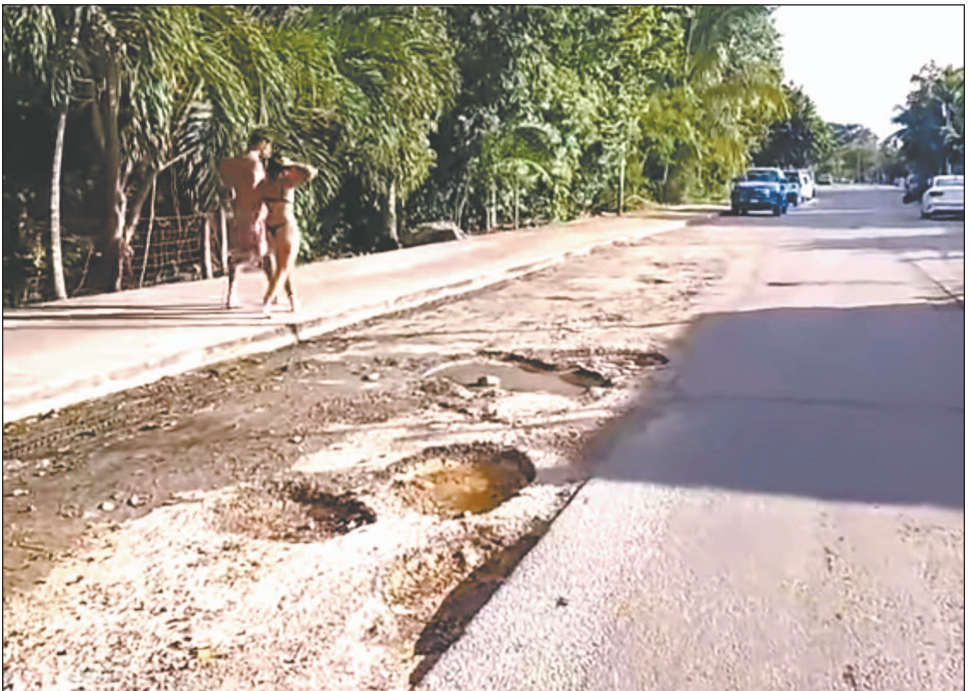
La arteria este sumamente deteriorada, lo que preocupa a la población, que exige al Gobierno municipal acciones urgentes para evitar más percances y mejorar la seguridad vial. (PorEsto!)
