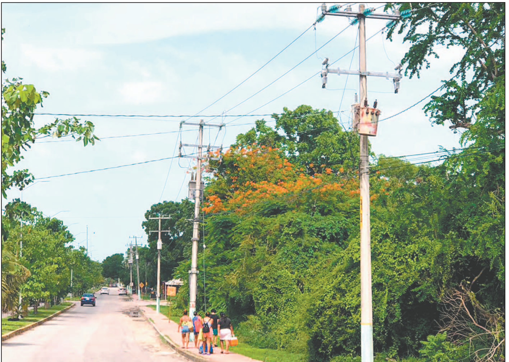
Residentes comentaron que las suspensiones de energía se deben a la sobrecarga en el tendido y debido a que la infraestructura tiene aproximadamente 40 años. (W. Duran)
