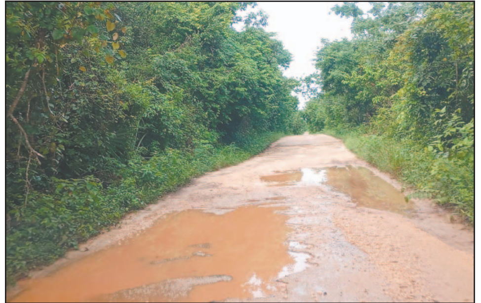
Los aguaceros causaron la pérdida de pavimento, se formen charcos y lodazales.
