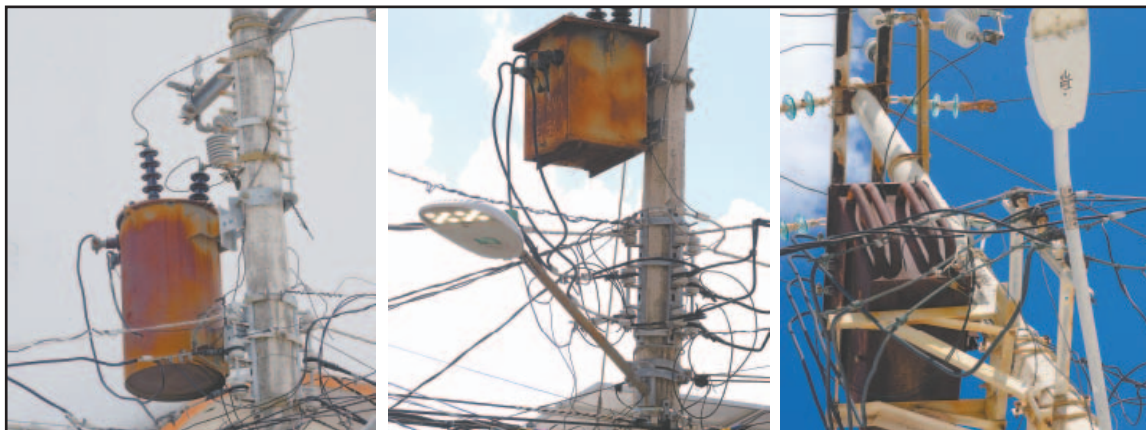
Un recorrido de PorEsto! constató los problemas en los amplificadores de la CFE. (Fotos Mario Hernández)
