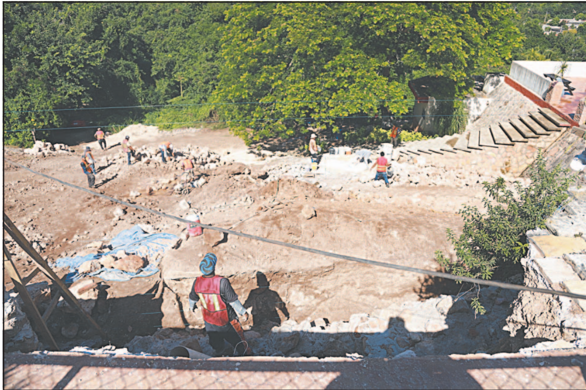
A principios de octubre del 2024 colapsó parte de esta histórica edificación, lo que obligó a cerrarla.
