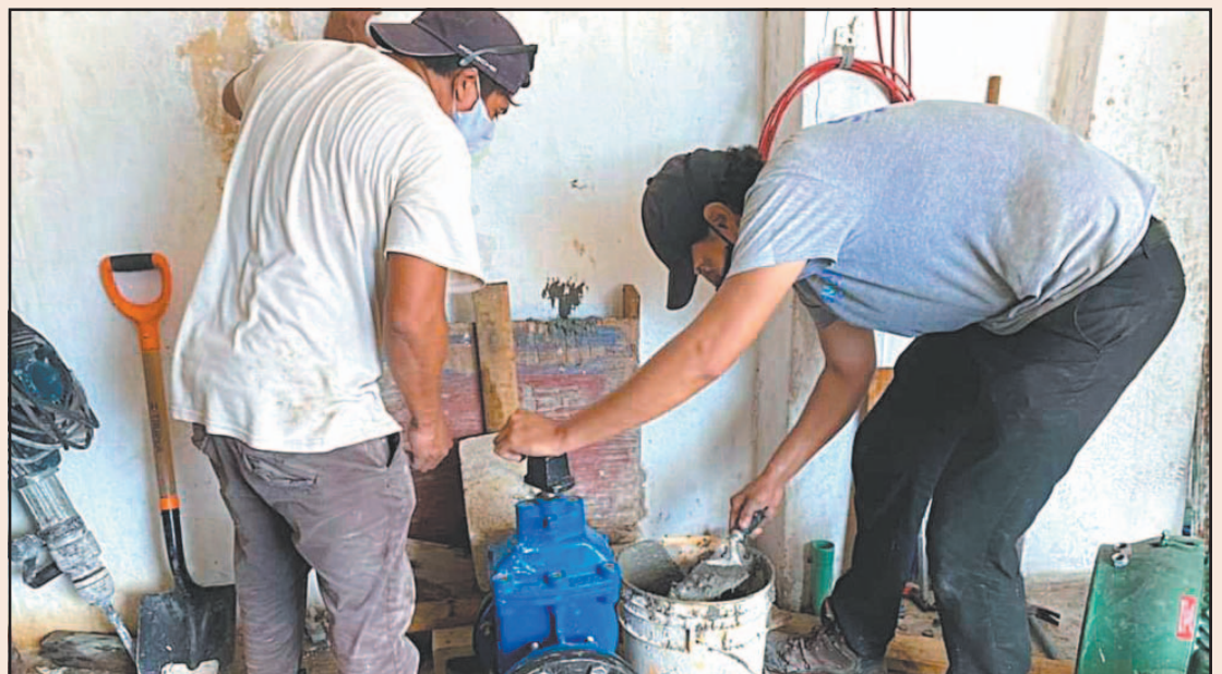
Se busca evitar fallas en el bombeo del agua para que los hogares cuenten con un buen servicio.
