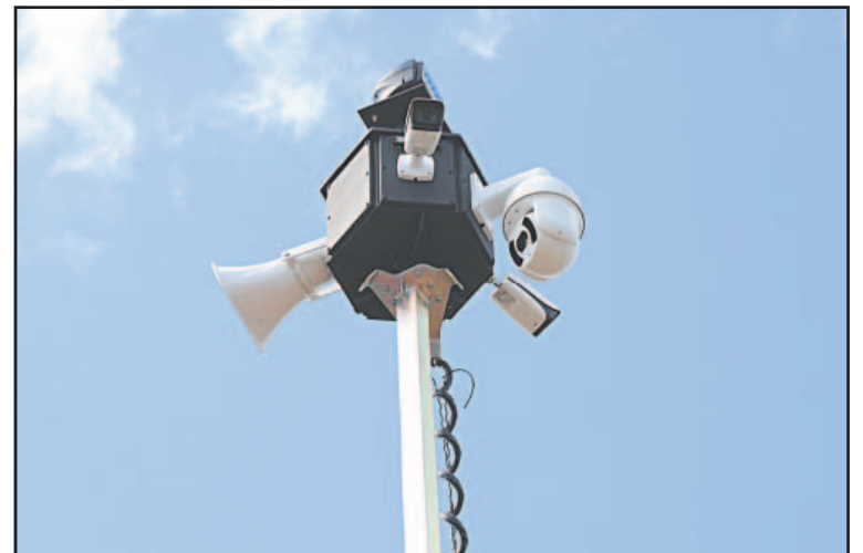
Las videocámaras cuentan con seguimiento de placas y personas.
