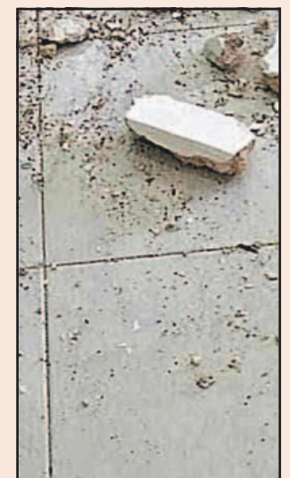
Comienza a desprenderse el techo de un salón.
