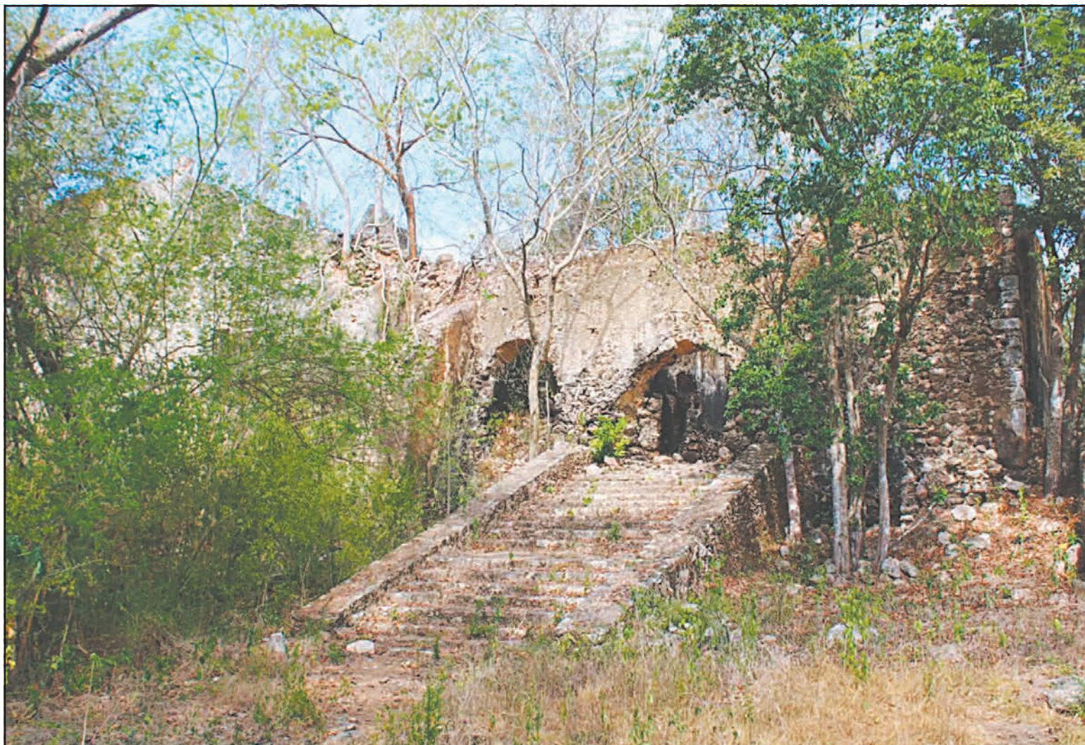
El historiador Leobardo Cox compartió fotos de los daños en la antigua parroquia dedicada a la Virgen de la Asunción. (POR ESTO!)
