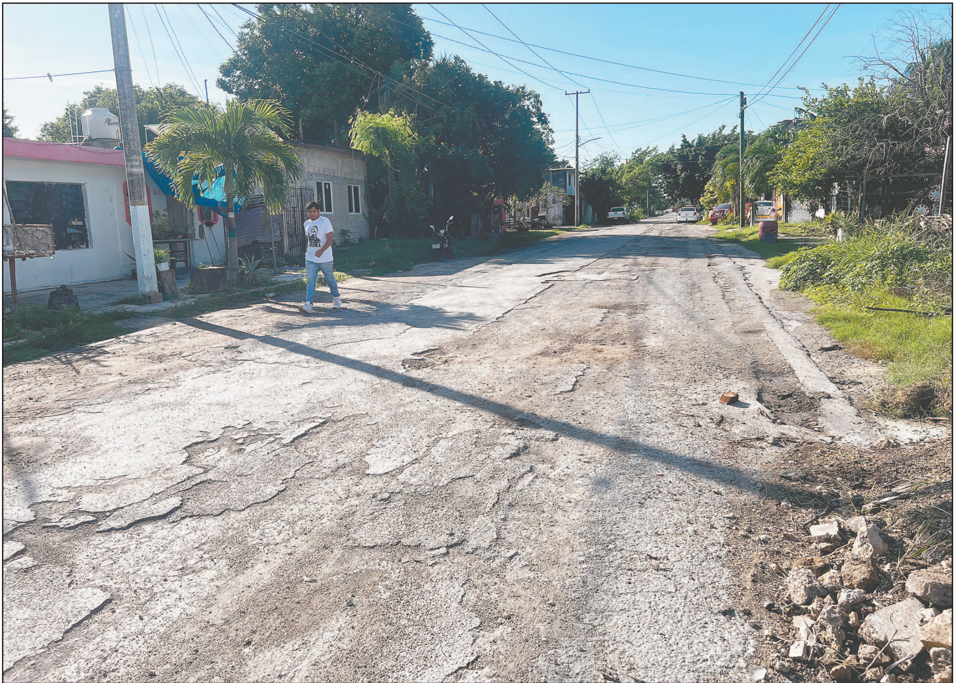
Hundimientos, charcos persistentes y asfalto deteriorado complican accesos domiciliarios en la Vicente Guerrero, única arteria excluida de la repavimentación reciente. (Efrén Martín)
