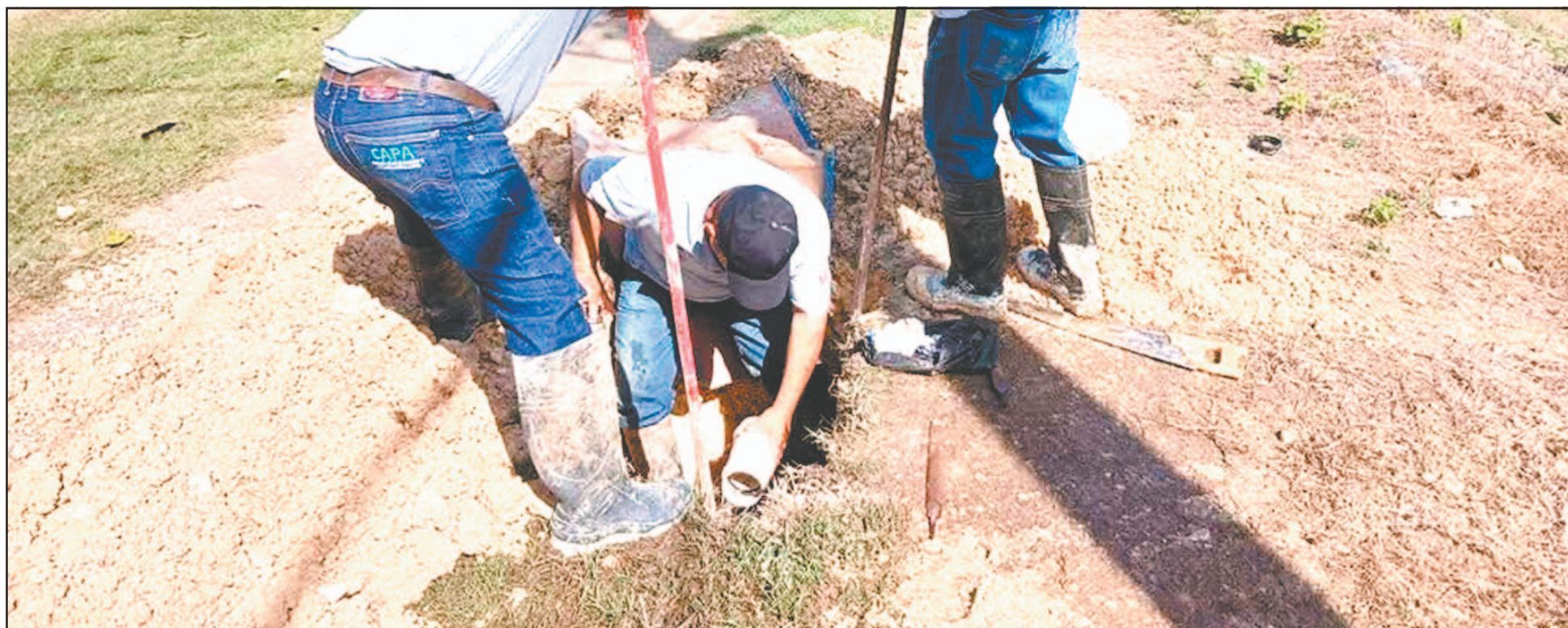
Un funcionario señaló que ayer atendieron dos reportes ante abundante pérdida de líquido y tienen contemplado solucionar problemas en otros puntos. (Fotos E. Cauich)
