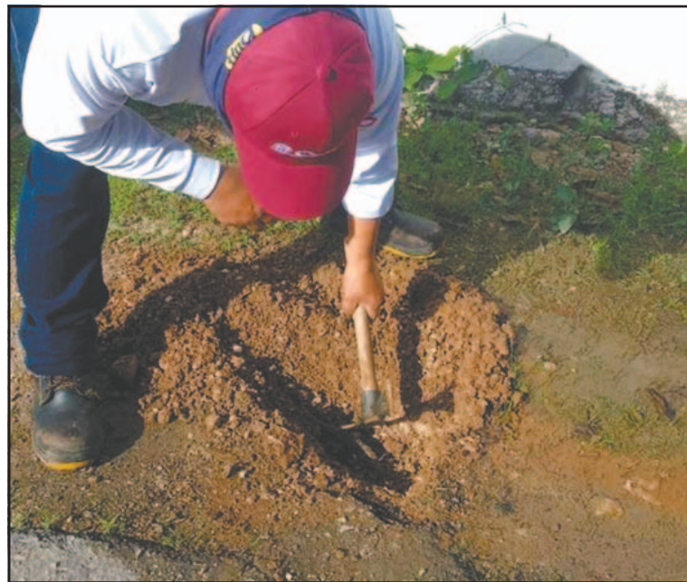
Llaman pobladores a la compañía a renovar todo el sistema hidráulico.
