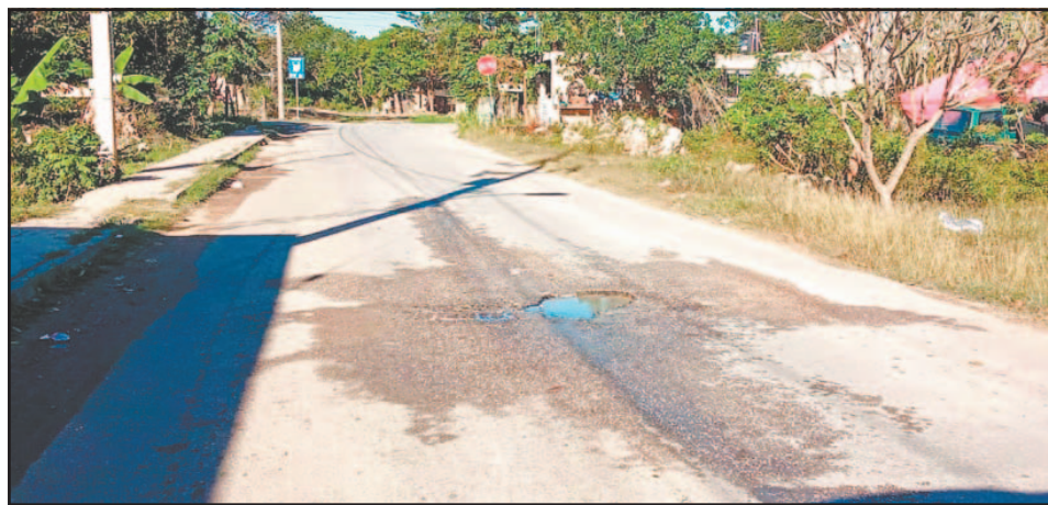
Dijeron quejosos que la vetusta red genera que continuamente se presenten filtraciones.
