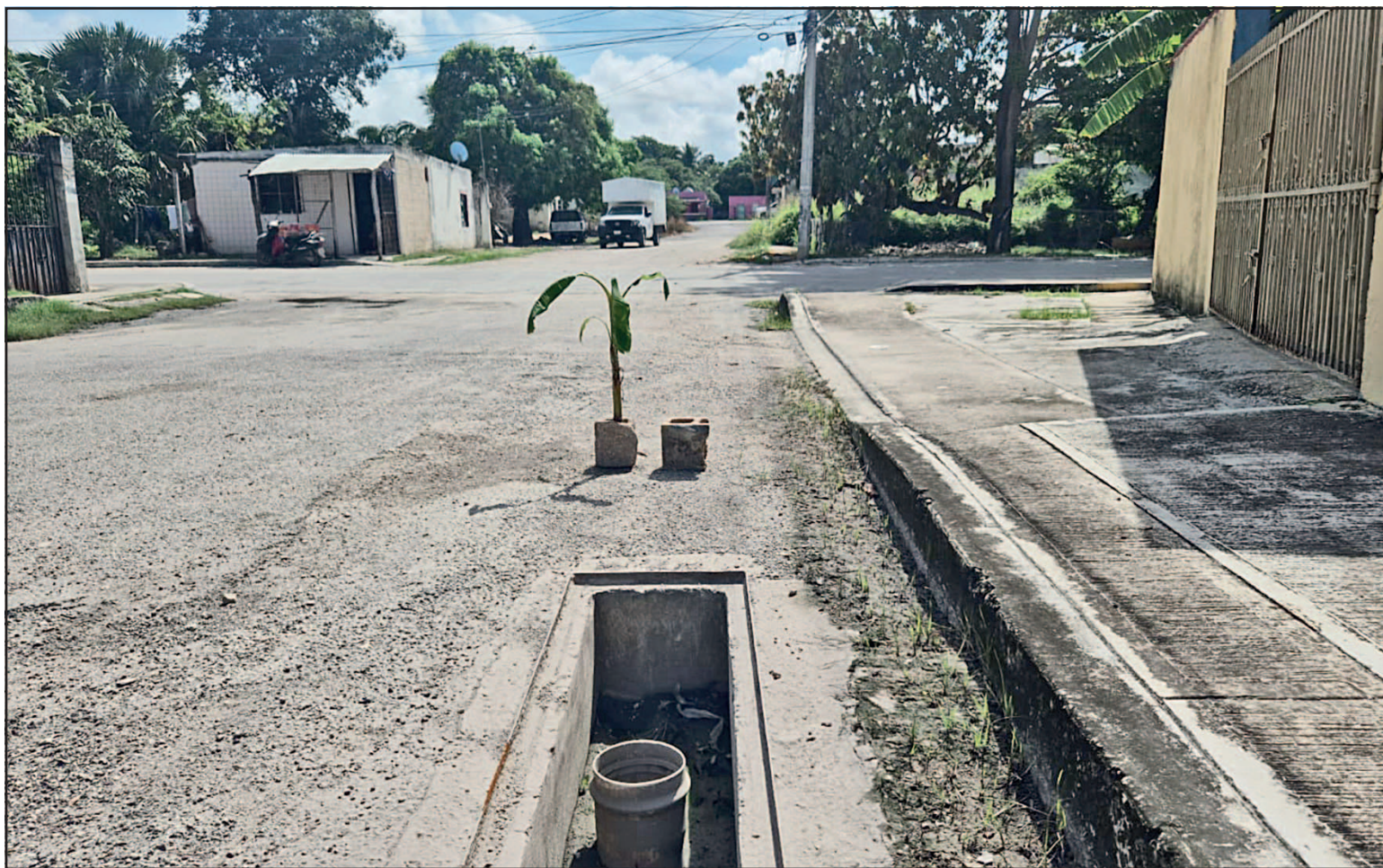
Solicitan la intervención del ayuntamiento para que se instale una nueva tapadera junto con otra lámpara para el alumbrado público.
