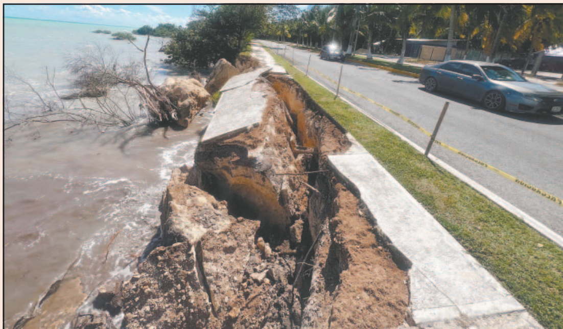
Un tramo de casi 20 metros de la banqueta se desprendió en la zona conocida como El Arenal. (Efrén Martín)
