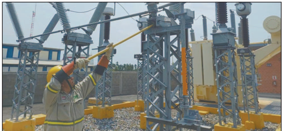
Casi 500 electricistas trabajan para atender a 361 mil hogares y mantener la continuidad del servicio.
