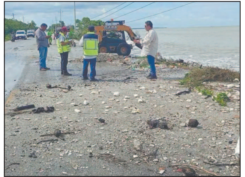
Personal del SICT acudió al tramo afectado para evaluar los daños.
