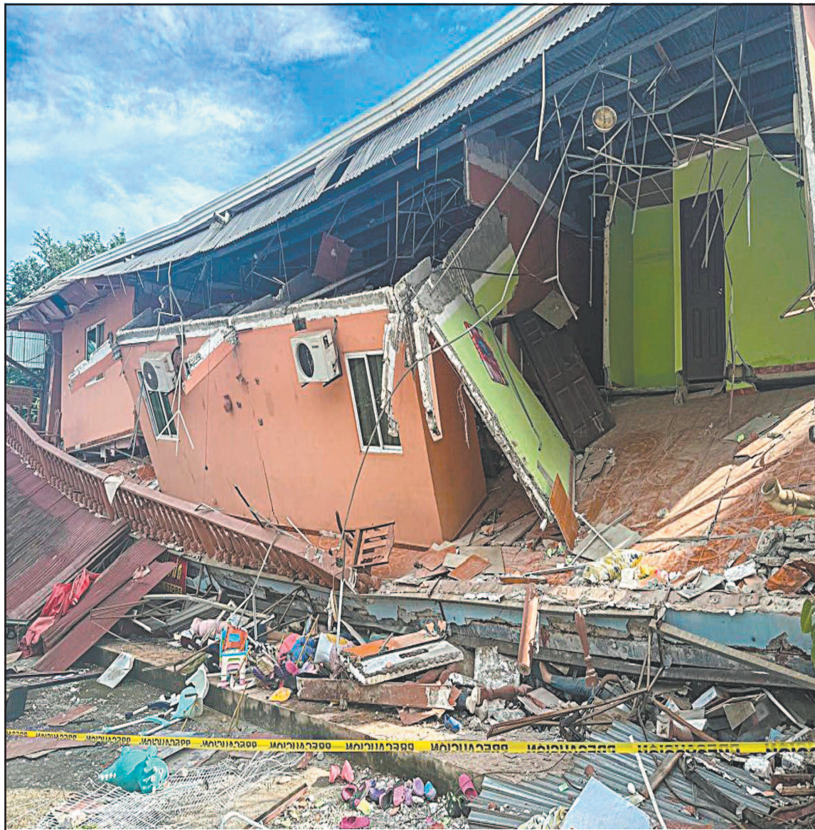
Más de medio millar de viviendas y edificios reportan daños de consideración tras los terremotos. (AFP)
