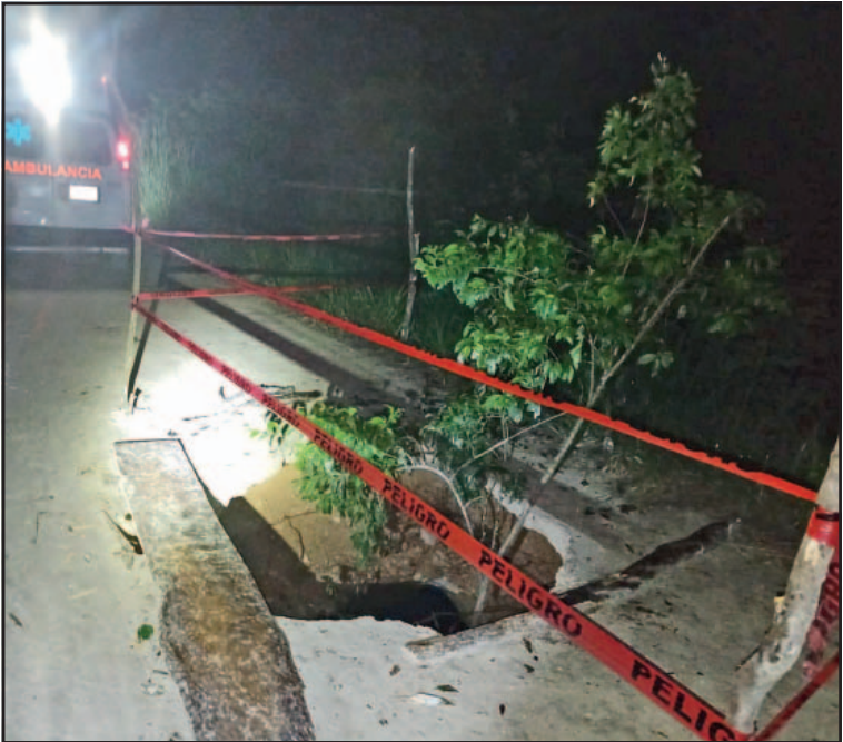
De noche es más peligroso porque no hay iluminación en el tramo.
