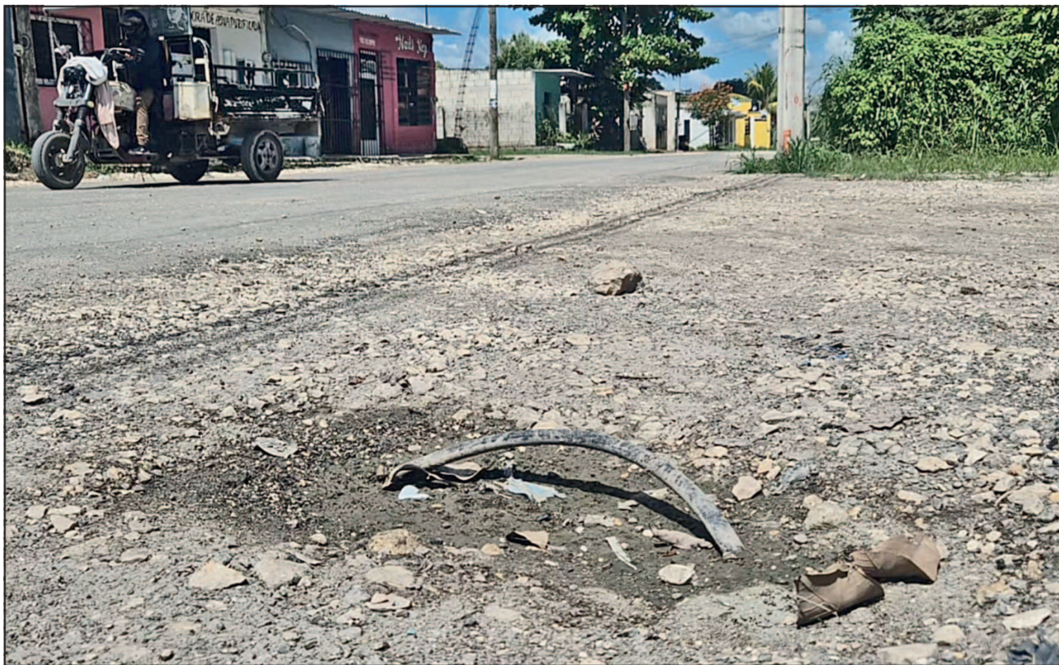
Durante la reparación de la vialidad, hace varios meses, los trabajadores dejaron el problema para los vecinos de la calle Isabel la Católica.
