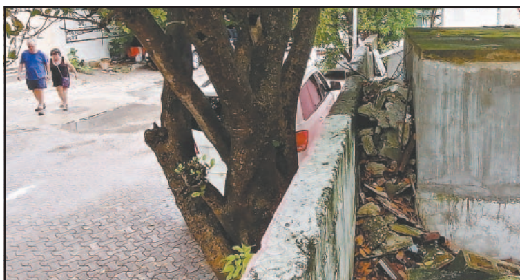
Un muro de 54 metros corre el riesgo de colapsar. (Ovidio López)
