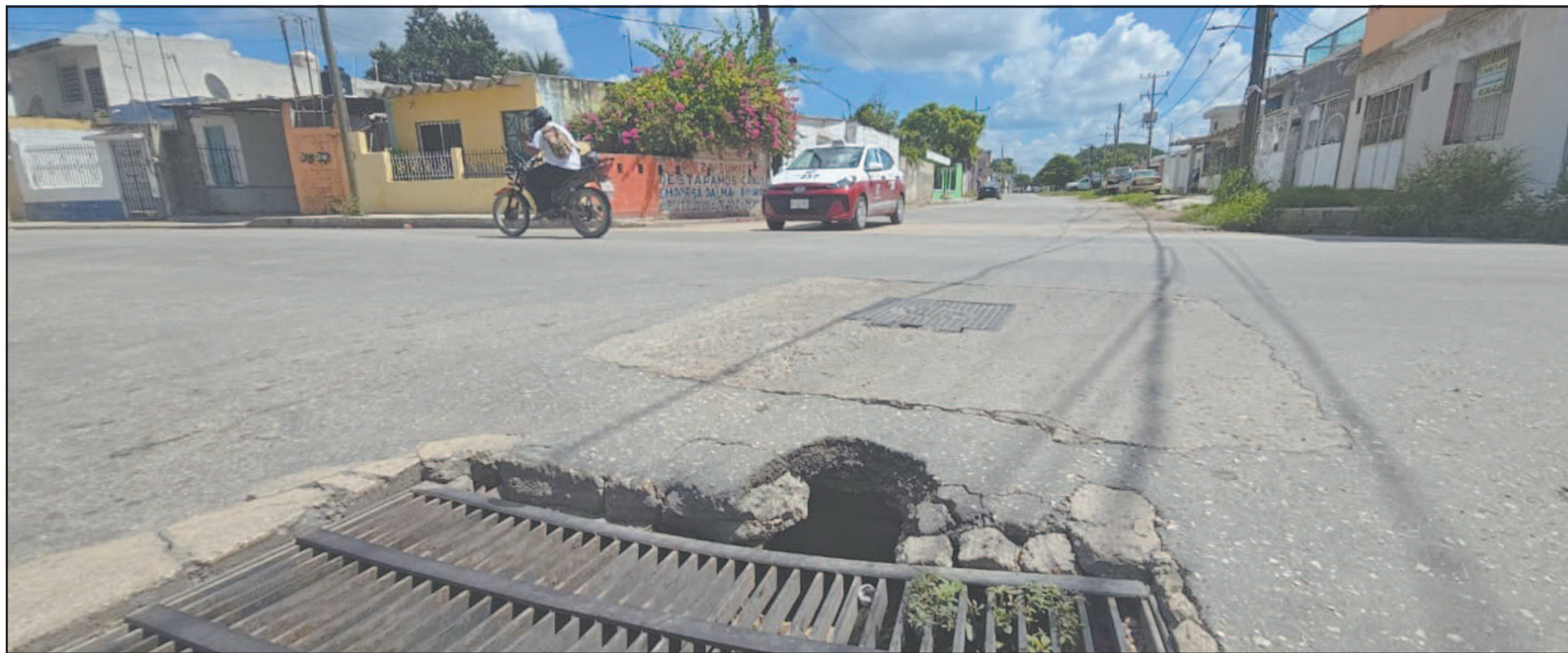
La intersección con las calles 105 y Uno presenta el daño señalado por los colonos. Automovilistas realizan maniobras para esquivar el desperfecto en su trayecto hacia Gobernadores.
