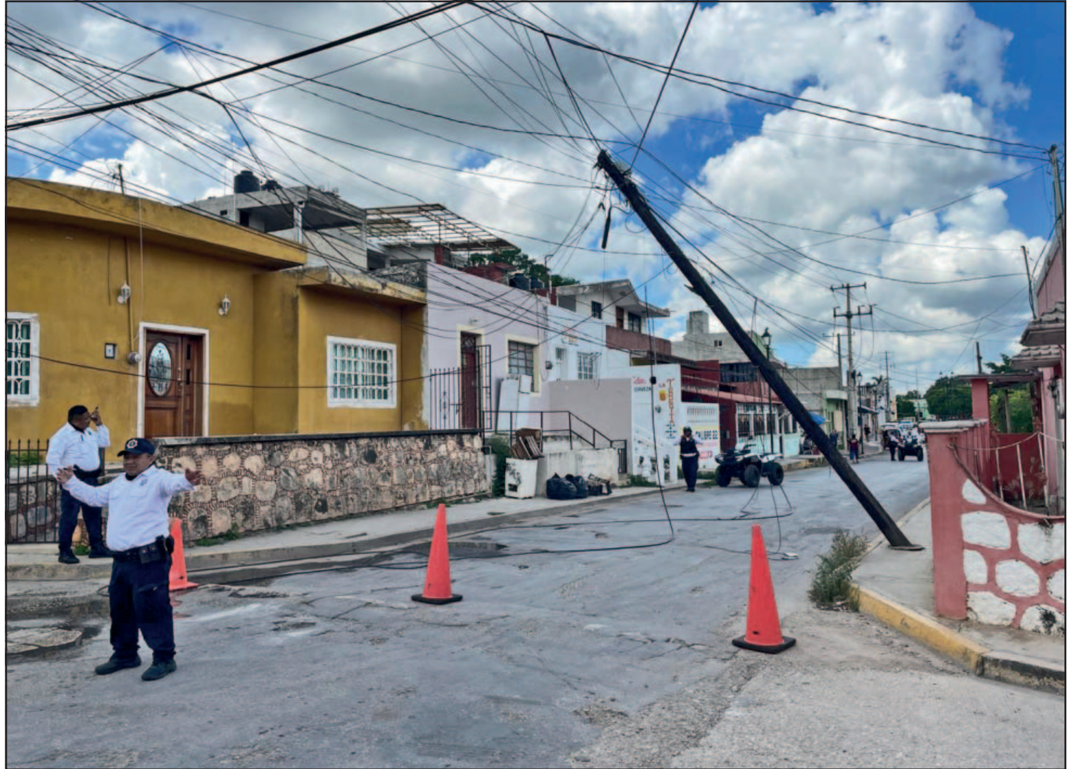
La estructura muestra deterioro desde su base, lo que le hizo ceder ante su peso y terminar en una postura de peligrosidad. (POR ESTO!)
