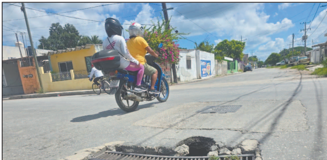
Los residentes solicitaron desazolver el pozo de absorción para reducir las inundaciones recurrentes.
